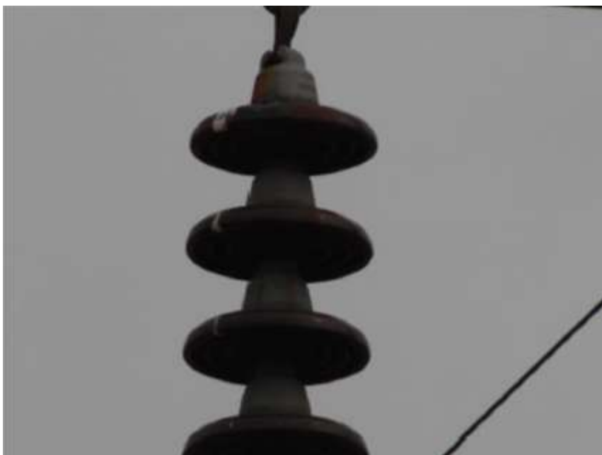
Fotografía N°1 - Estructura N°70 del tramo de línea Los Maquis – Hualañé, donde se produce falla.
