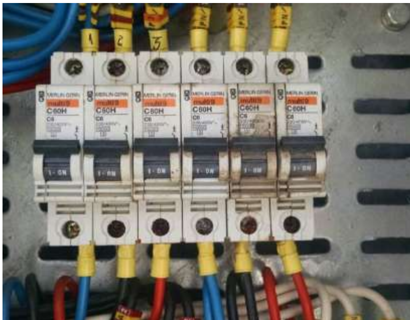
Fotografía N°5 – Termo-magnético correspondiente al transformador de potencial de la fase C, paño B4 de SE Los Maquis, con salida aislada (apertura del circuito). Dicho interruptor magnético fue cambiado el día 04-01-2017.
