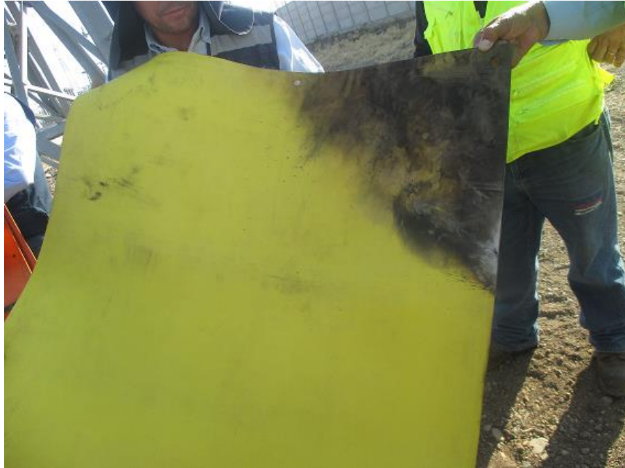
Fotografía N°2. Manta aislada instalada en puente fase superior afectada por la descarga
