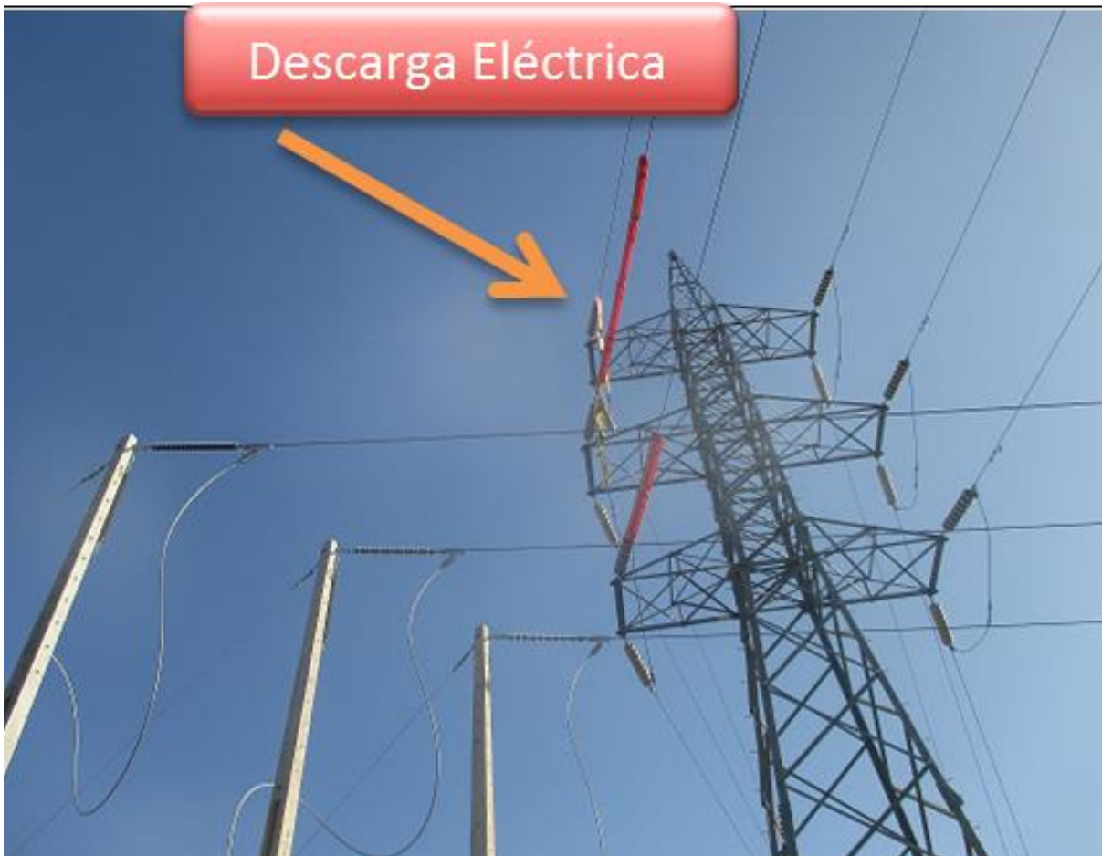
Fotografía N°1. Punto de descarga en LT 66 KV Pan de Azúcar – El Peñón, Estructura N°218, común con LT 110KV Pan de Azúcar – El Peñón la cual también se vió afectada sin presentar daños en sus conductores.
