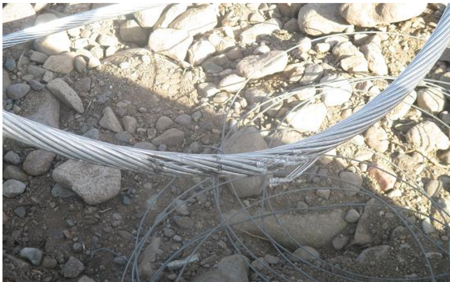
Fotografía N°3. Conductor de by pass afectado por la descarga.
