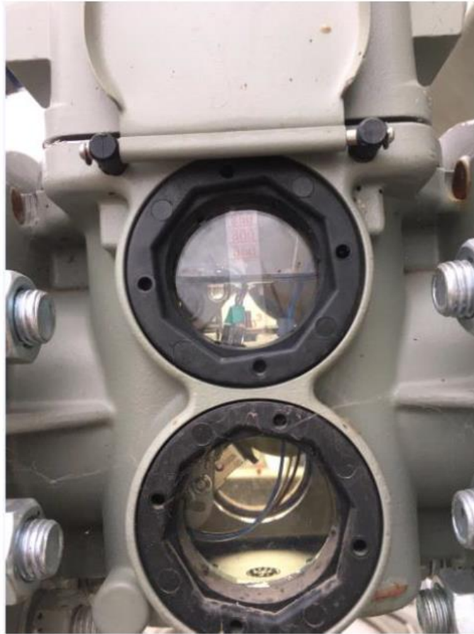
Figura N°8. Visor del relé Buchholz con aire en su interior.
