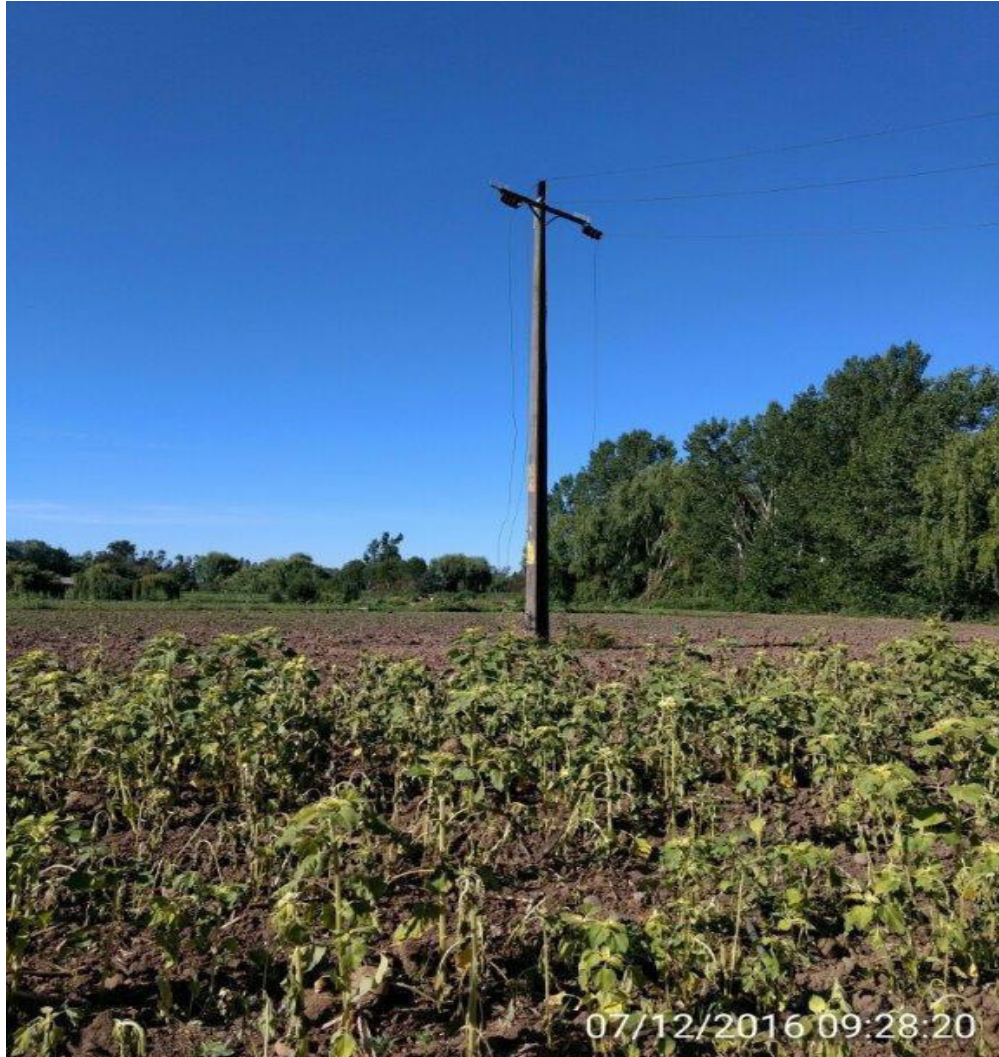
Línea 66KV Tramo Villa Alegre-Linares Norte Estructura N°147.
