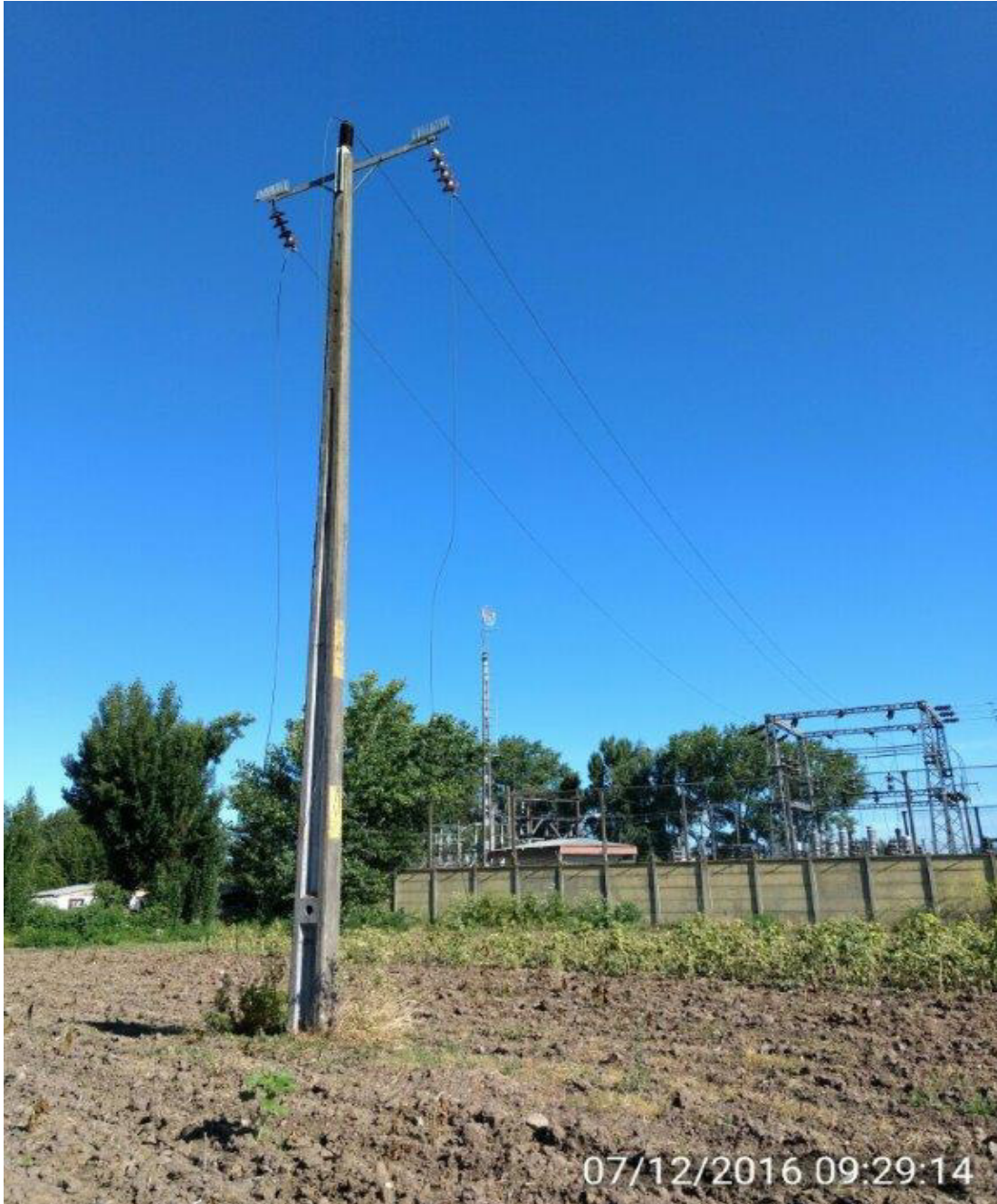
Estructura N°147 Instalaciones dañadas por vándalos. Robo de conductor.
