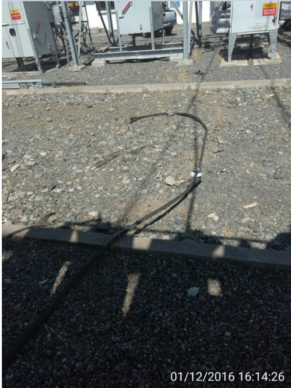
Se muestra conductor en el suelo asociado a puente de barra auxiliar del transformador N° 1 66/13,2kV 25MVA
