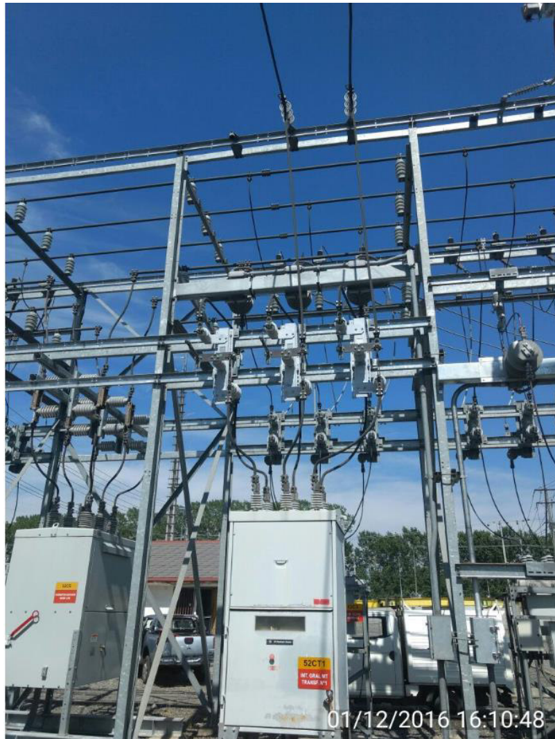
Se muestra paño CT1 sin cadena de aisladores asociado a barra auxiliar del transformador N° 1 66/13,2kV 25MVA
