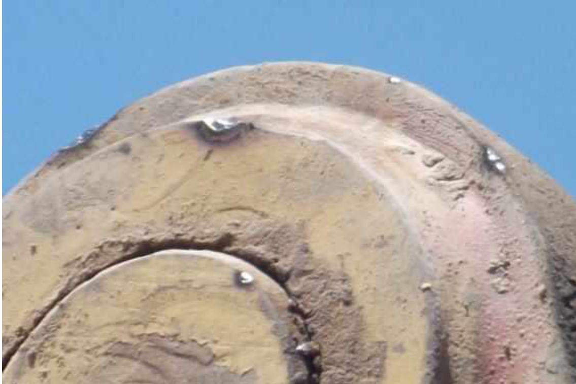
Señales de descarga eléctrica en máquina excavadora, debido al acortamiento de distancia a línea 66kV Pan de Azúcar – Marquesa
