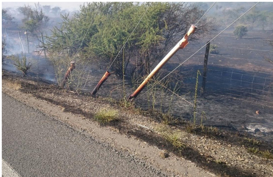
Foto 5: Imagen de la zona afectada bajo la LT 110kV Quelentaro - Portezuelo
