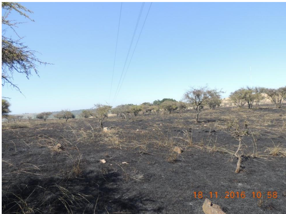
Foto 7, 8 y 9: Estructura N° 36 y tramo de LT Quelentaro – Portezuelo tras paso de incendio.
