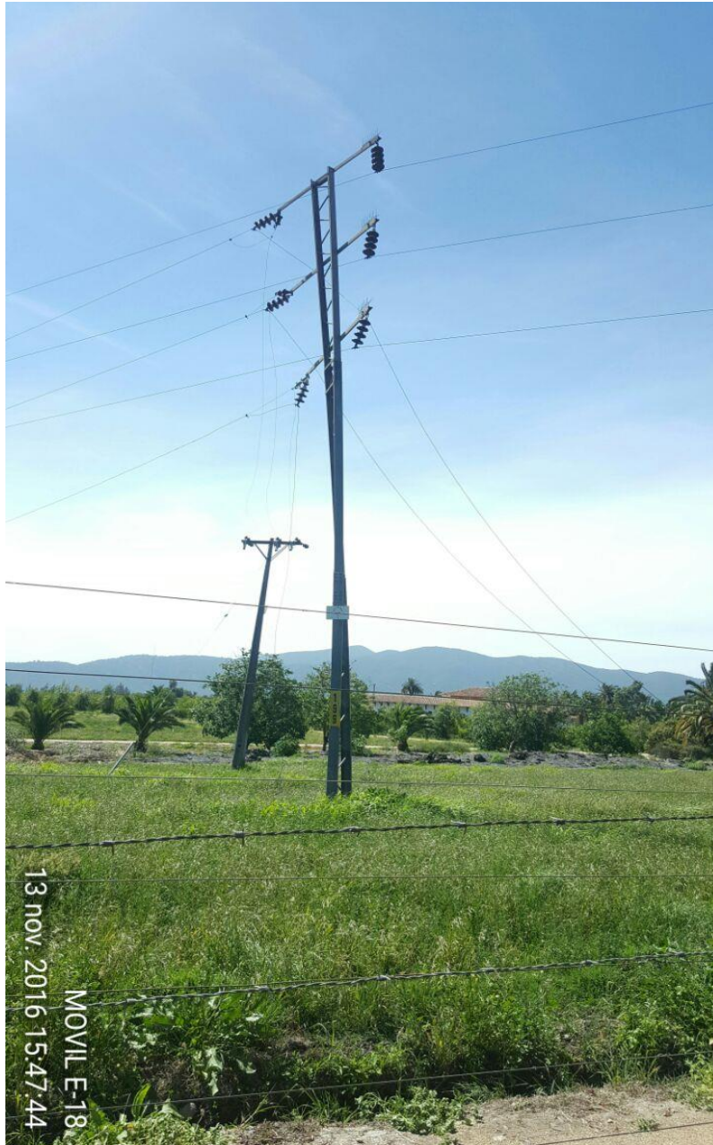
Fotografía N° 2: Líneas cortadas de MT en doble circuito en estructura N° 199.
