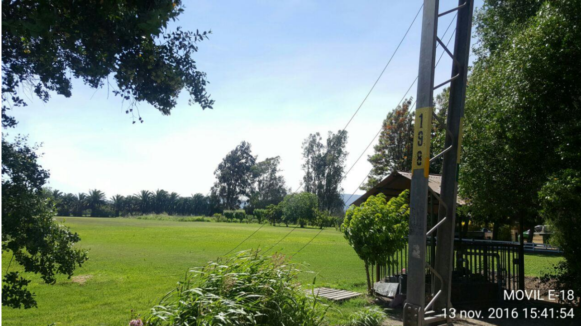
Fotografía N° 1: Se observa el conductor cortado de MT entre las estructuras N°198 y 199 del tramo LT66 kV El Maitén – El Paico
