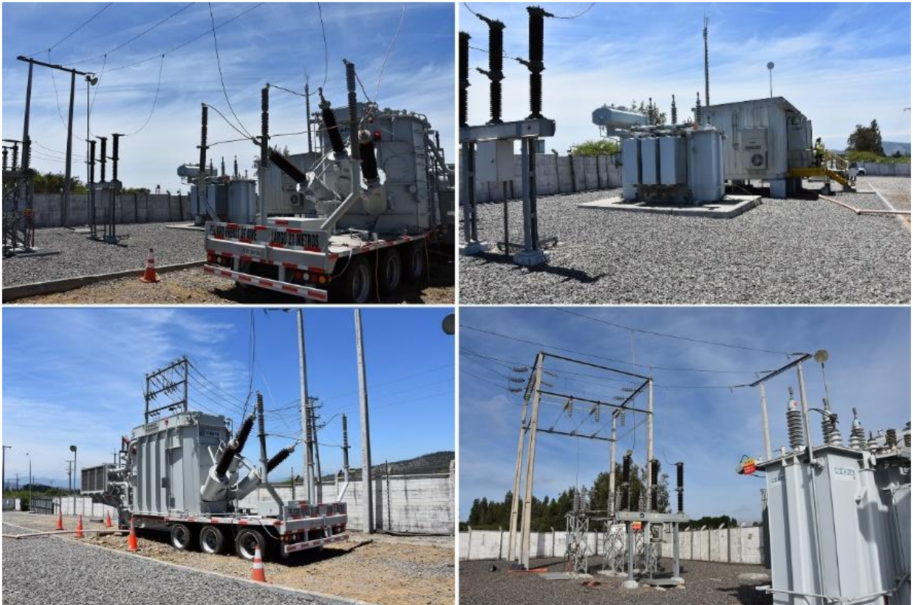
LAS FOTOGRAFÍAS MUESTRAN VISTAS GENERALES DE SE LA MANGA, CON TRANSFORMADOR MÓVIL EN SERVICIO, EL DOMINGO 13 DE NOVIEMBRE.
