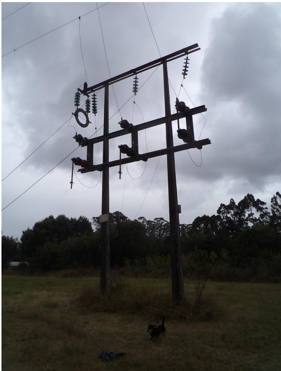
Fotografía N°1.- DD.FF Fusible fase A (bastón cerrado) en arranque hacia ferrocarriles EFE Metrenco. Los bastones adyacentes se encontraban abiertos previos al evento de la falla.
