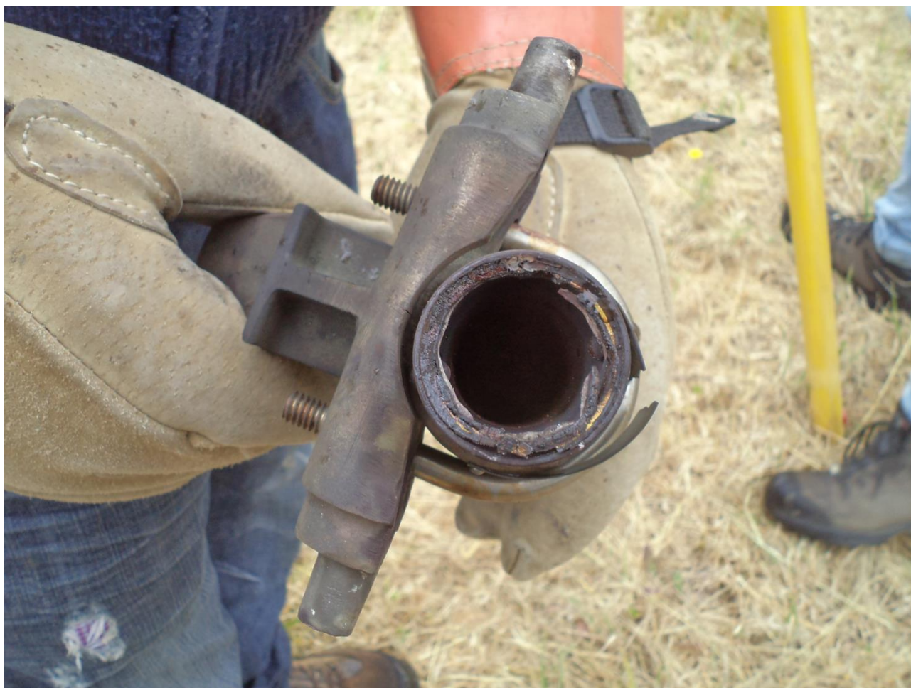
Fotografía N°2.- Detalle de mecanismo interior de bastón fase A en DD.FF de Tap Off Metrenco.
