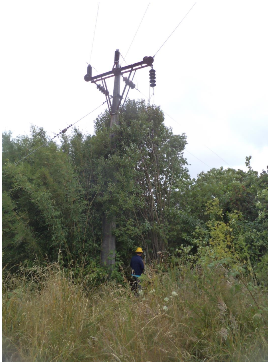
Fotografía N°3.- Línea lateral cortada perteneciente al arranque Tap Off ferrocarriles Metrenco.
