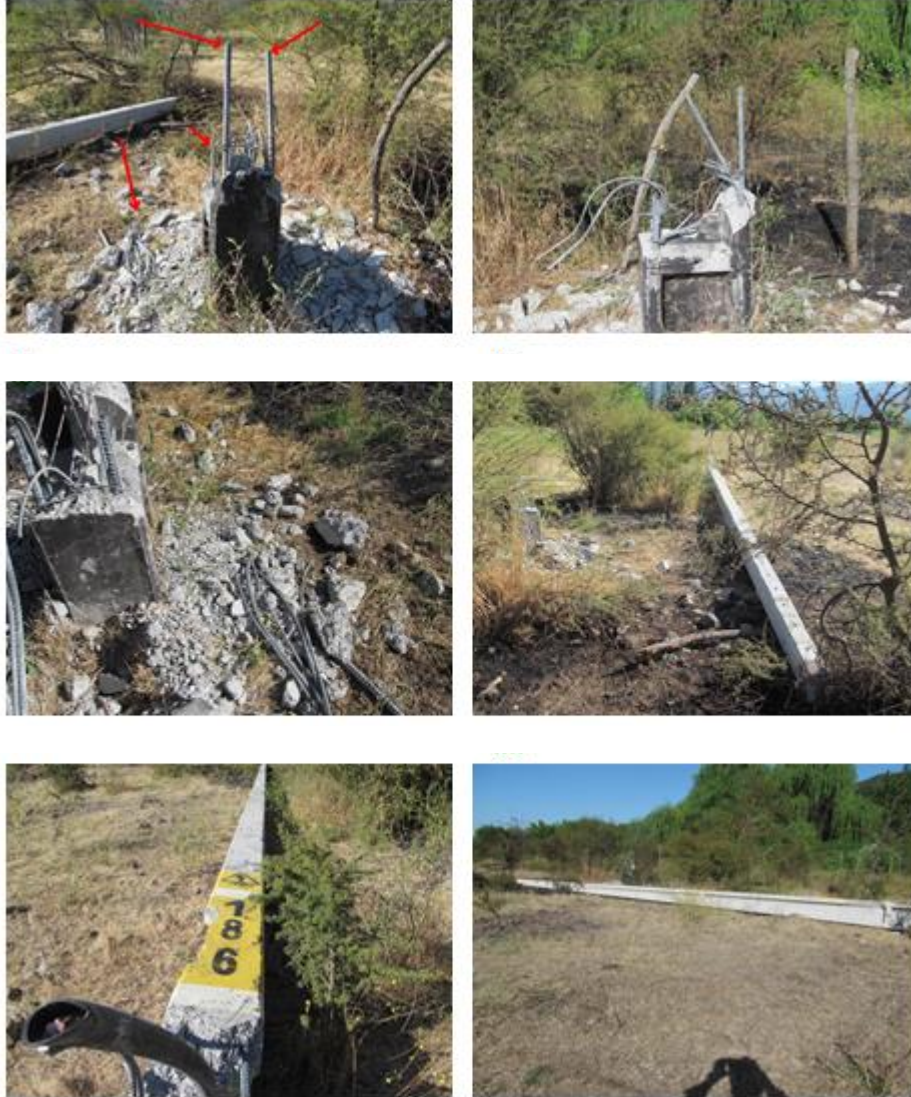
Foto 2: Estructura N° 186 dañada por acto vandálico
