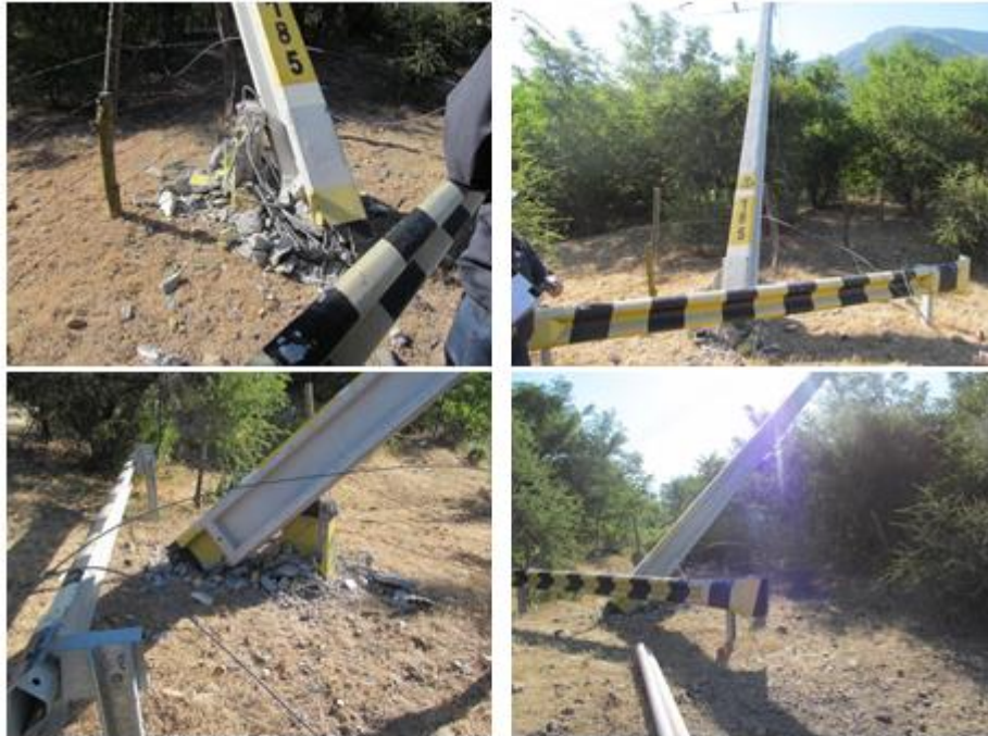
Foto 1: Estructura N° 185 dañada por acto vandálico
