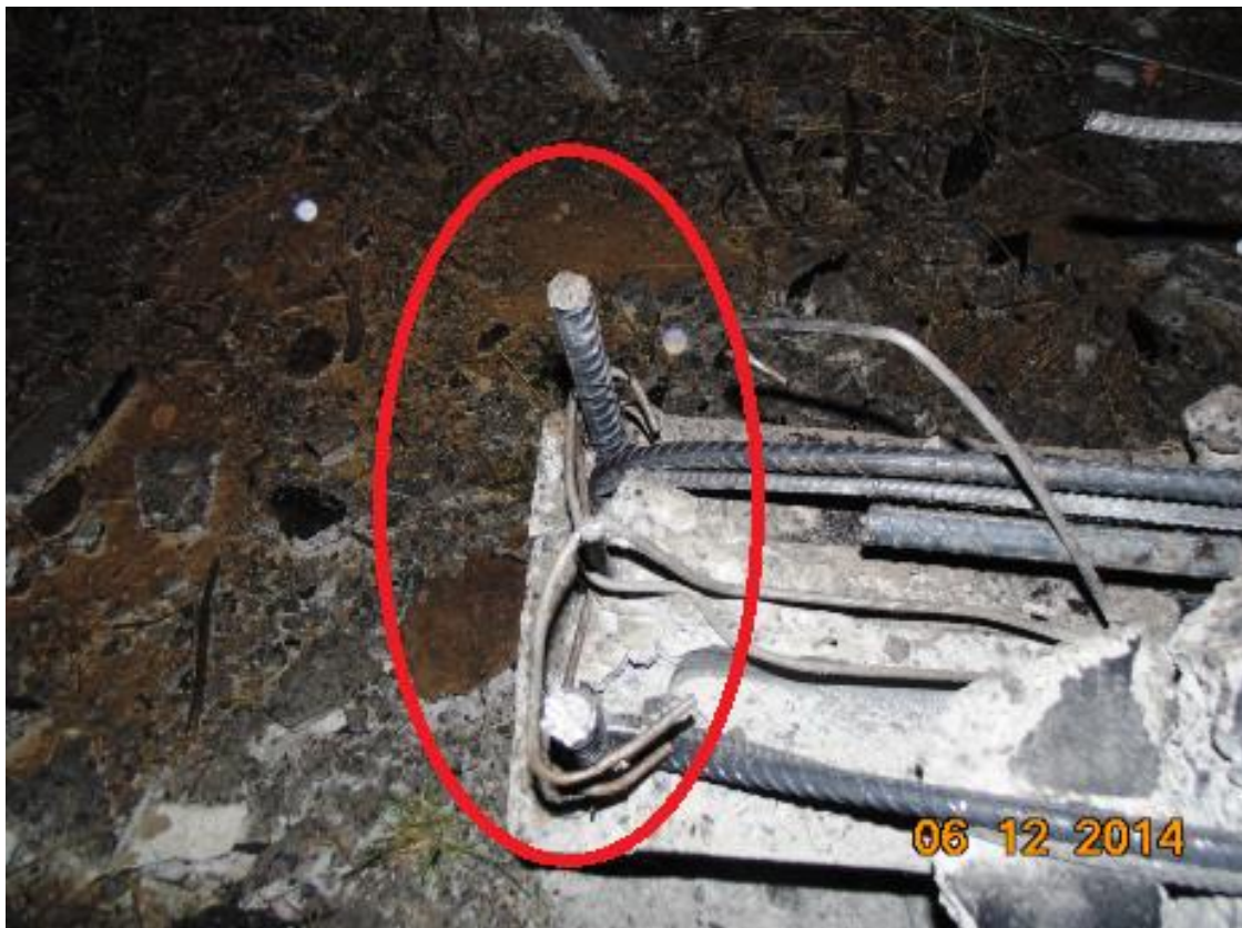
Foto 2: Postes quebrado y conductores cortados por acto vandálico, en estructura N° 118. Puede observarse que la enfierradura fue cortada con sierra en la base del poste de hormigón armado.
