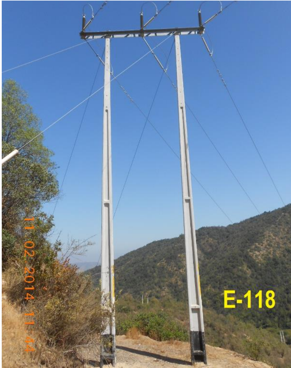
Foto 1: Estructura de anclaje N° 118, antes del acto vandálico.
