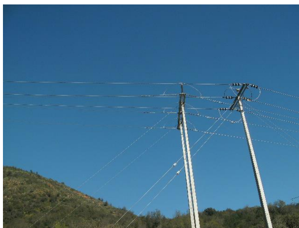
FOTOS NROS. 7, 8 y 9.- Panorámica Líneas propiedad Transnet instaladas Sector Cuesta Alhué ruta G-680.-
