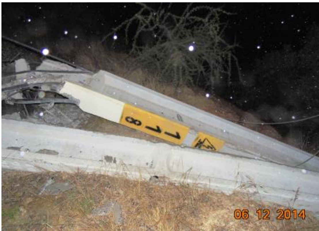
Foto 3: Postes quebrado y conductores cortados por acto vandálico, en estructura N° 118.
