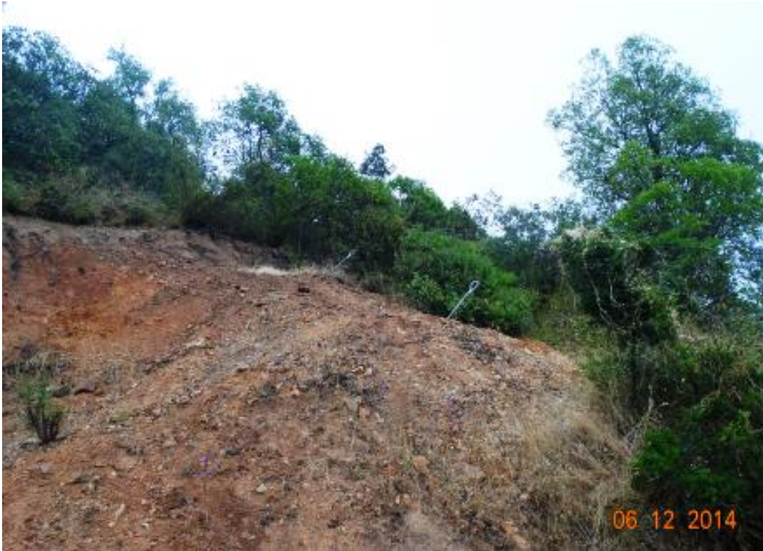
Foto 6: Tirantes cortados por terceros durante acto vandálico, en estructura N° 118. En la fotografía se observan los restos de los anclajes (barras de tirantes) que quedaron a la vista luego de que se cortaran los tirantes.
