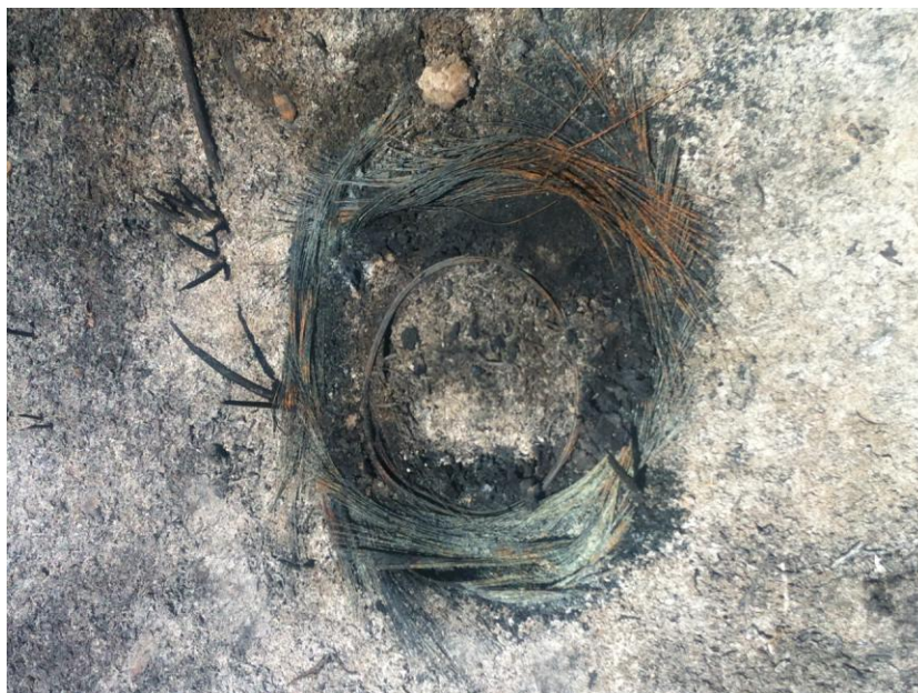
Figura 5. Fotografía que muestra elemento quemado encontrado debajo del vano afectado.
