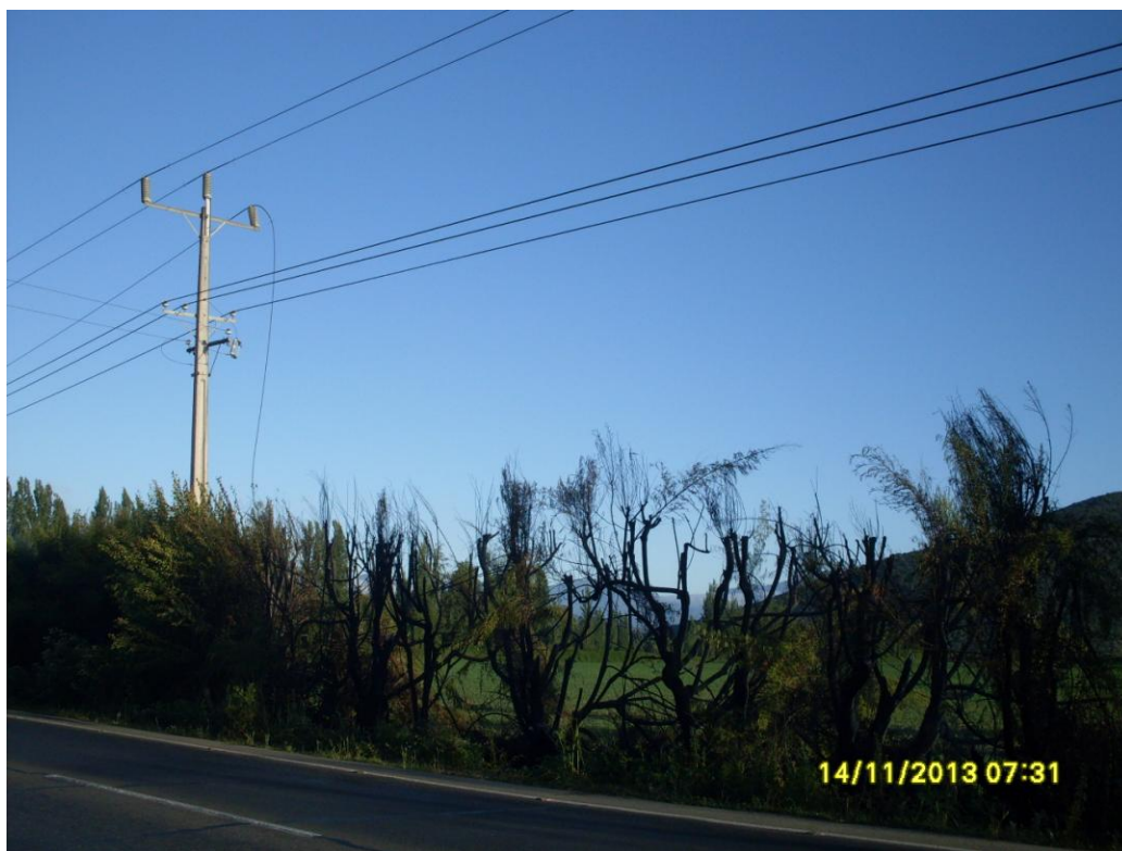
Figura 2. Fotografía que muestra el corte de conductor de la línea.
