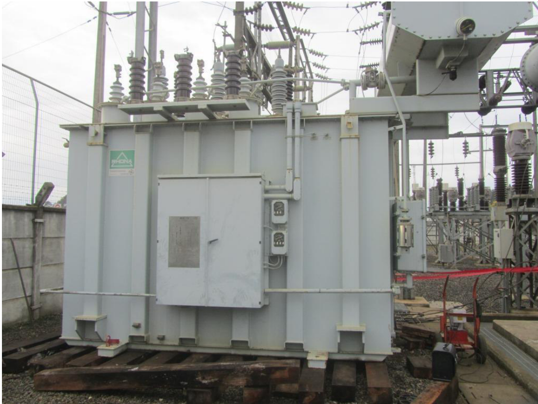
Transformador RHONA 20MVA Retirado de servicio.
