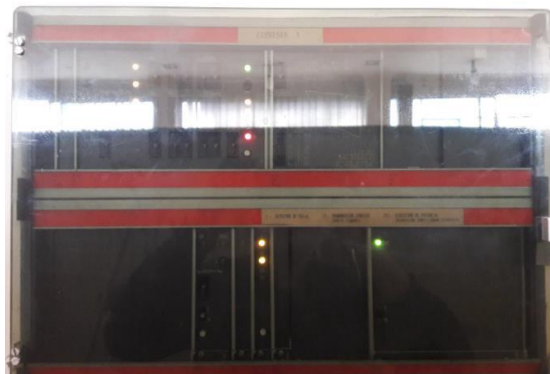
Registro Relé LZ92-1, paño A1, S/E Itahue, Sistema 2.
