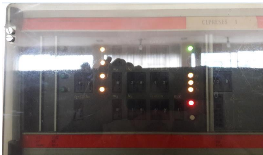
Registro Relé LZ92-1, paño A1, S/E Itahue, Sistema 2.
