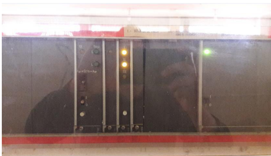
Registro Relé LZ92-1, paño A1, S/E Itahue, Sistema 2.
