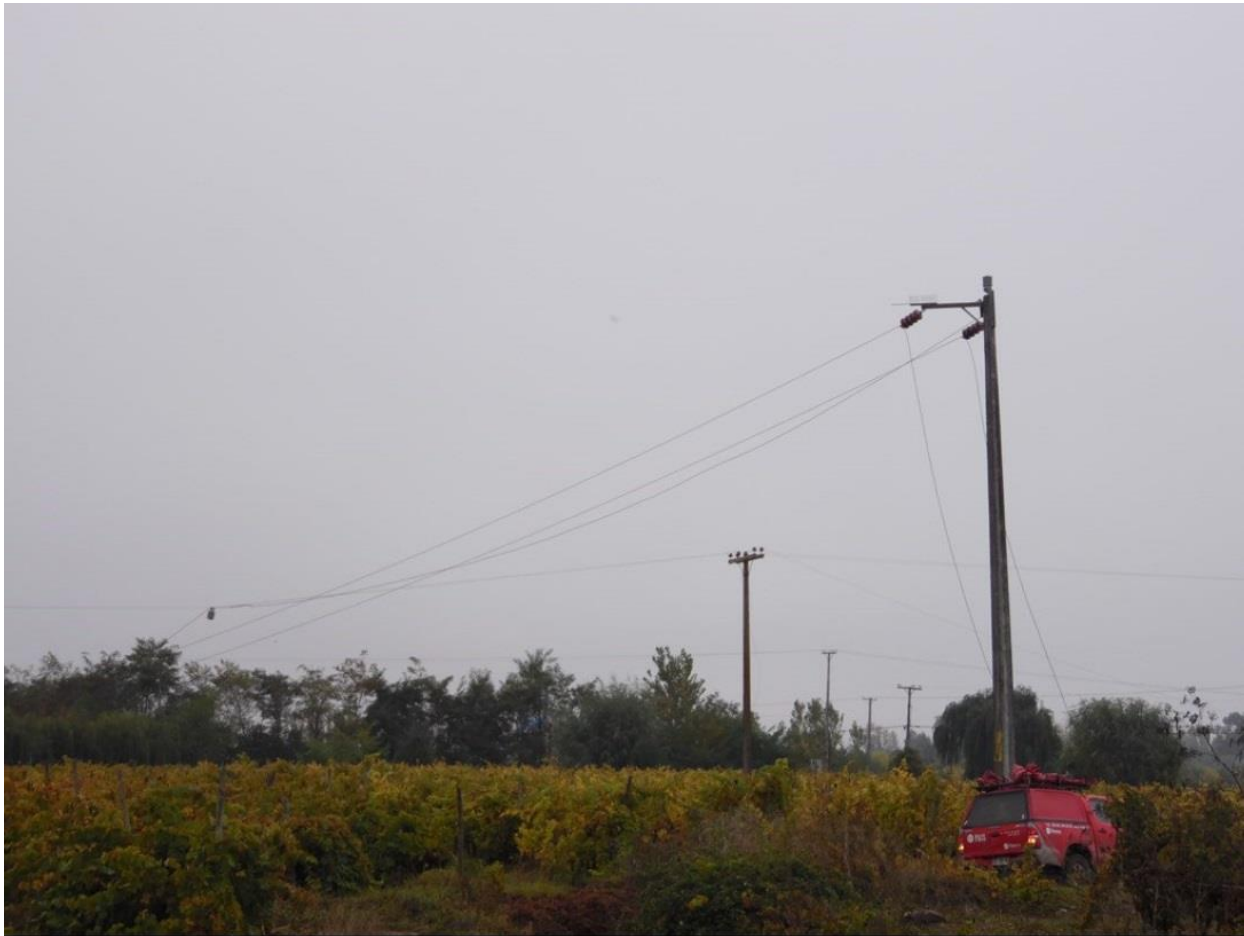
Fotografía N°1. Tramo línea 66 kV San Javier – Villa Alegre entre las estructuras N°132 y N°134 afectada por robo de conductor.
