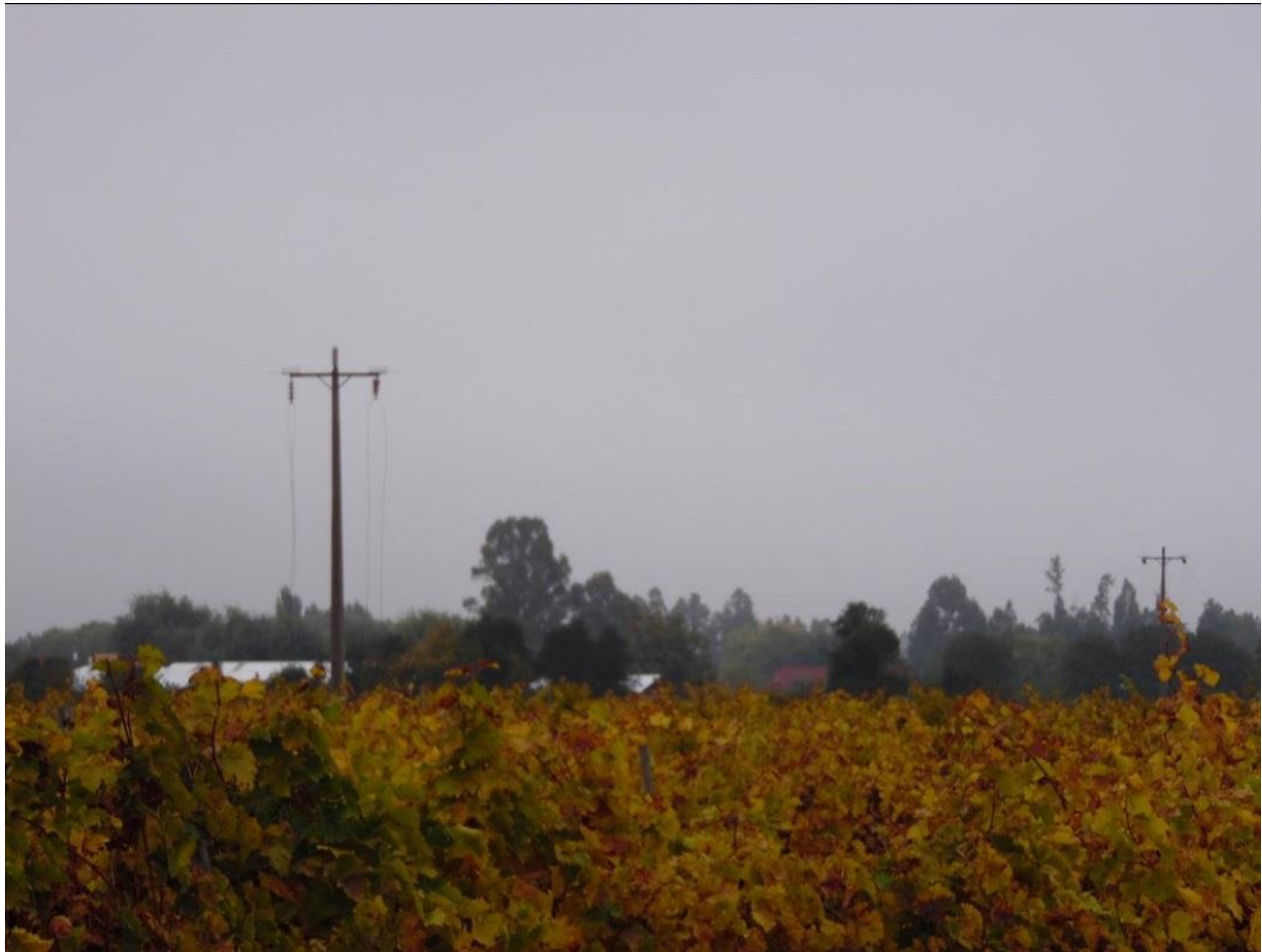
Fotografía N°2. Tramo línea 66 kV San Javier – Villa Alegre entre las estructuras N°132 y N°134 afectada por robo de conductor.
