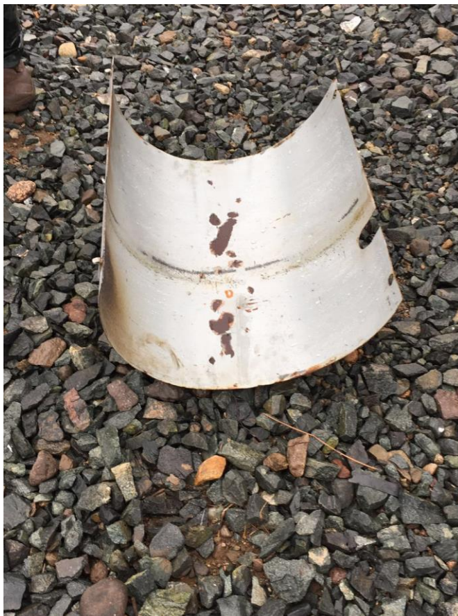
Fotografía N°1: Tapa del interruptor 52B2 SE El Peñon con evidente descarga eléctrica.
