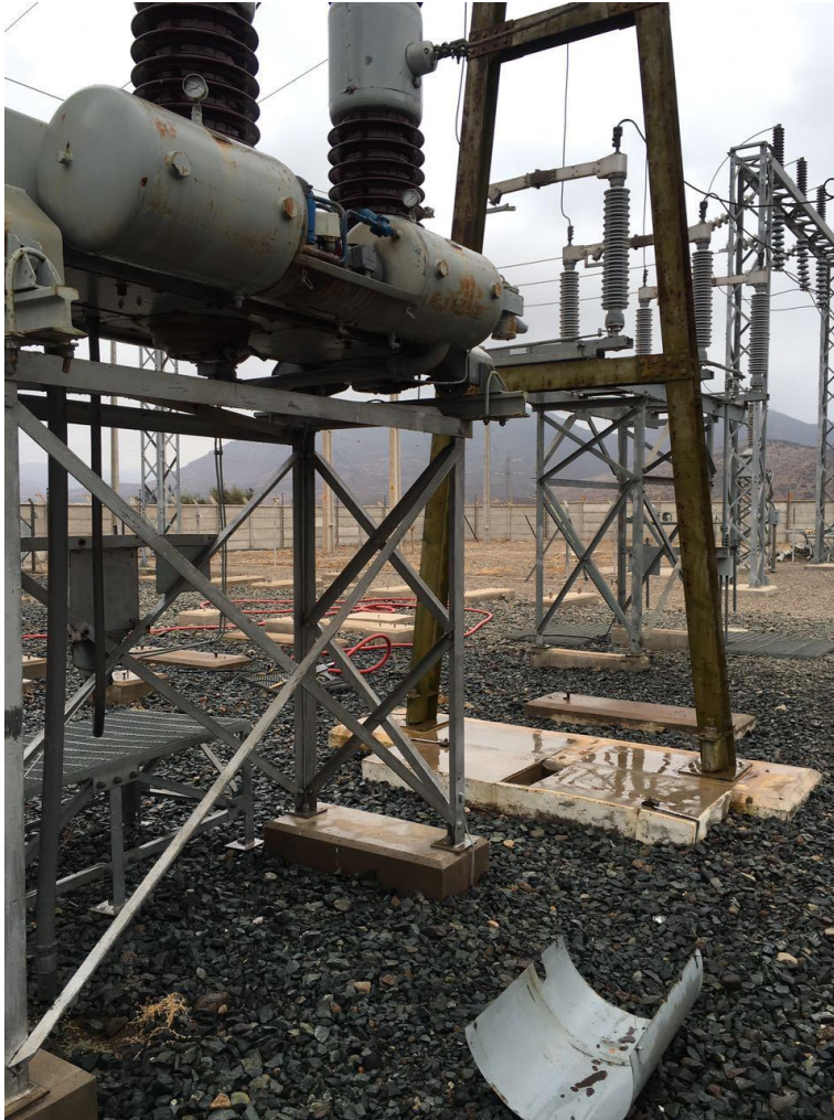
Fotografía N°3: Tapa de interruptor posterior a acortamiento de distancia eléctrica.
