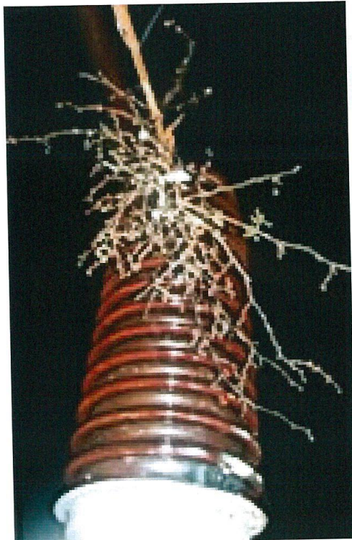
Rama en aislador line post estructura N°13
