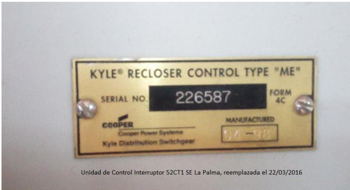
Fotografía N°1: Unidad de control fallada y retirada de Servicio Serie N° 226587, Marca: Cooper, Modelo: Form 4C
