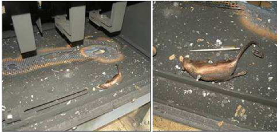
Evidencia roedor electrocutado – Piso interior del interruptor
