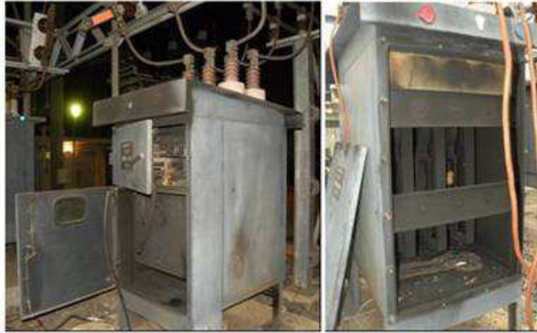
Interrupor 12 kV Acoplador B1-B2 – Vista frontal y posterior
