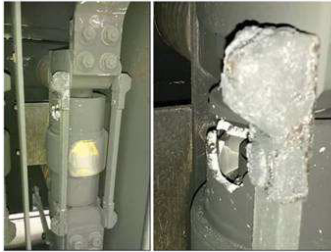
Interrupor Acoplador B1-B2 - Cámara Extinción de Arco fase Blanca
