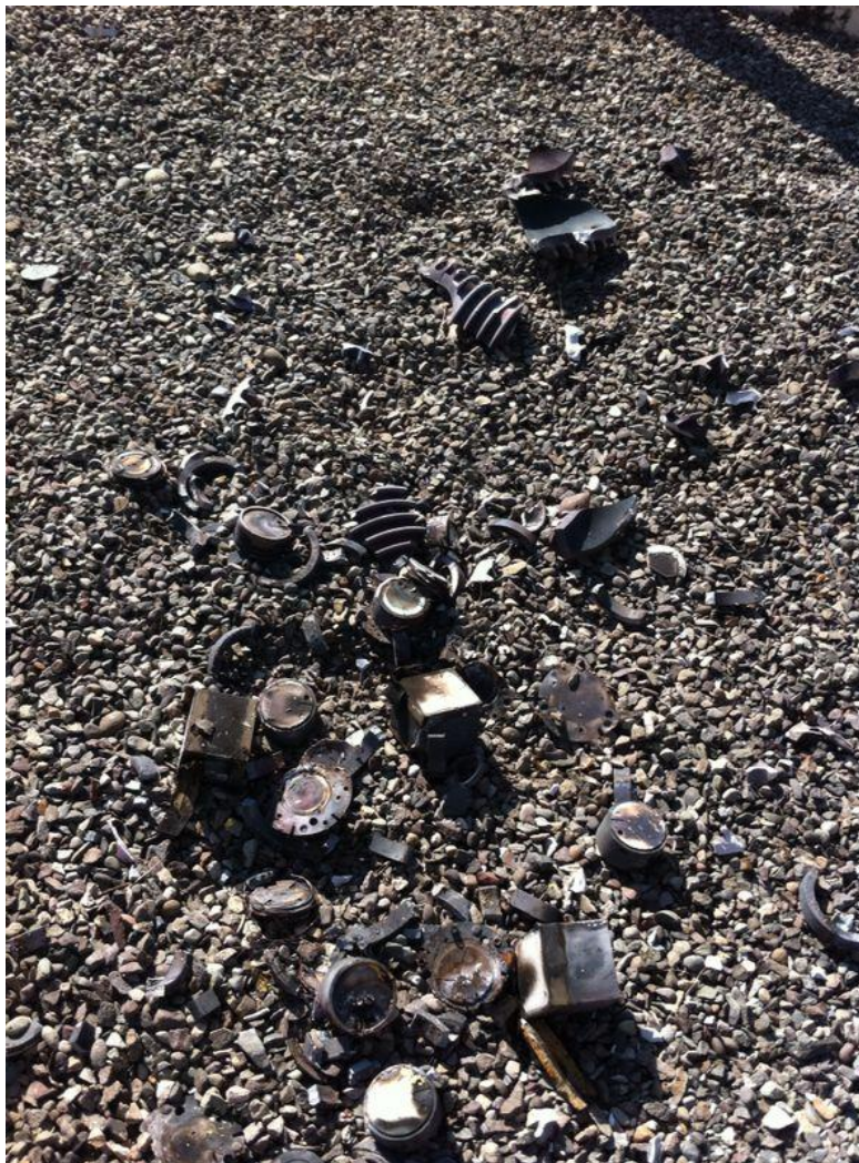
Restos del pararrayo afectado por la falla.
