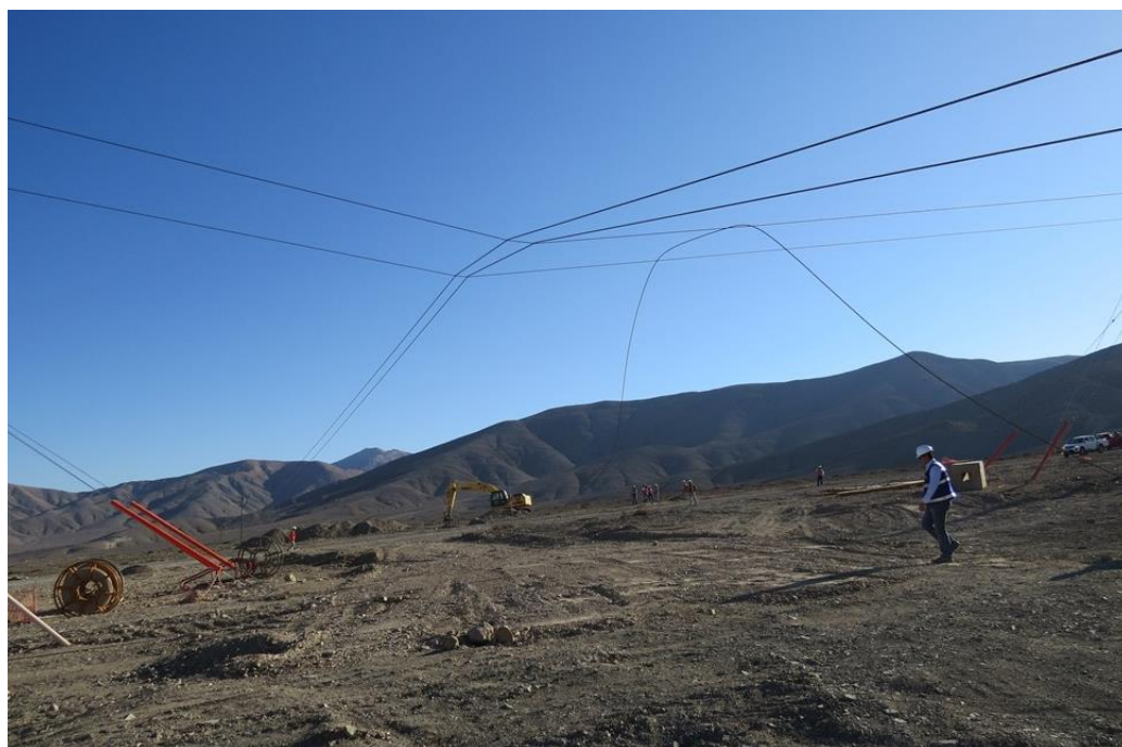
Fotografía N° 7. Conductores entre estructuras N° 42 y N°43 de LT.110 kV Cardones - Tierra Amarilla, apoyados en LT. 110 kV Cardones – Magnetita (CAP).
