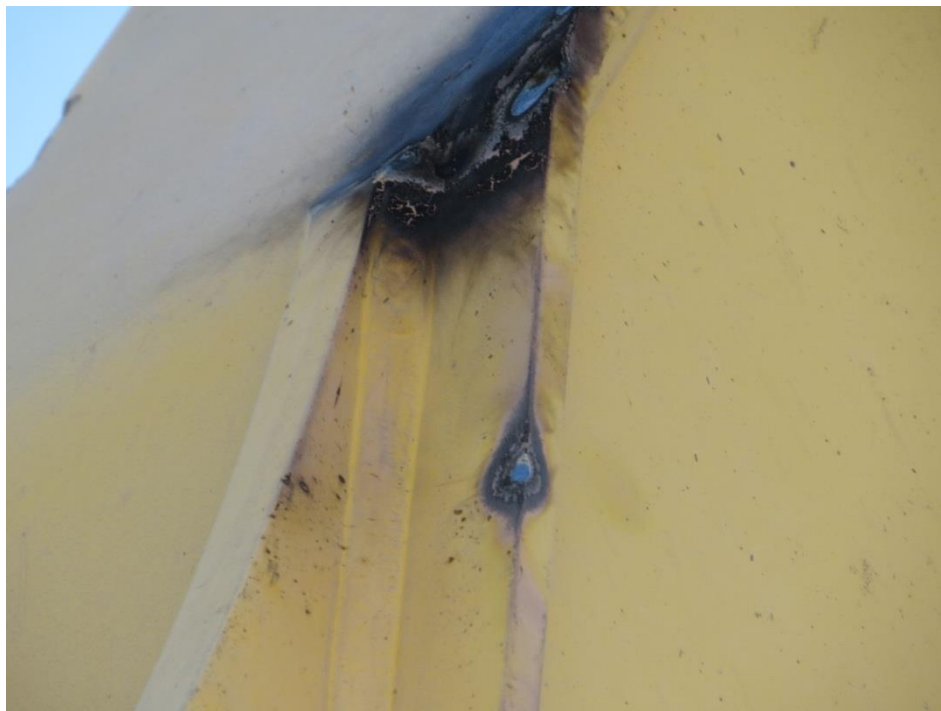
Fotografía N° 9. Evidencia de descarga en máquina retroexcavadora causante de los daños a la línea
