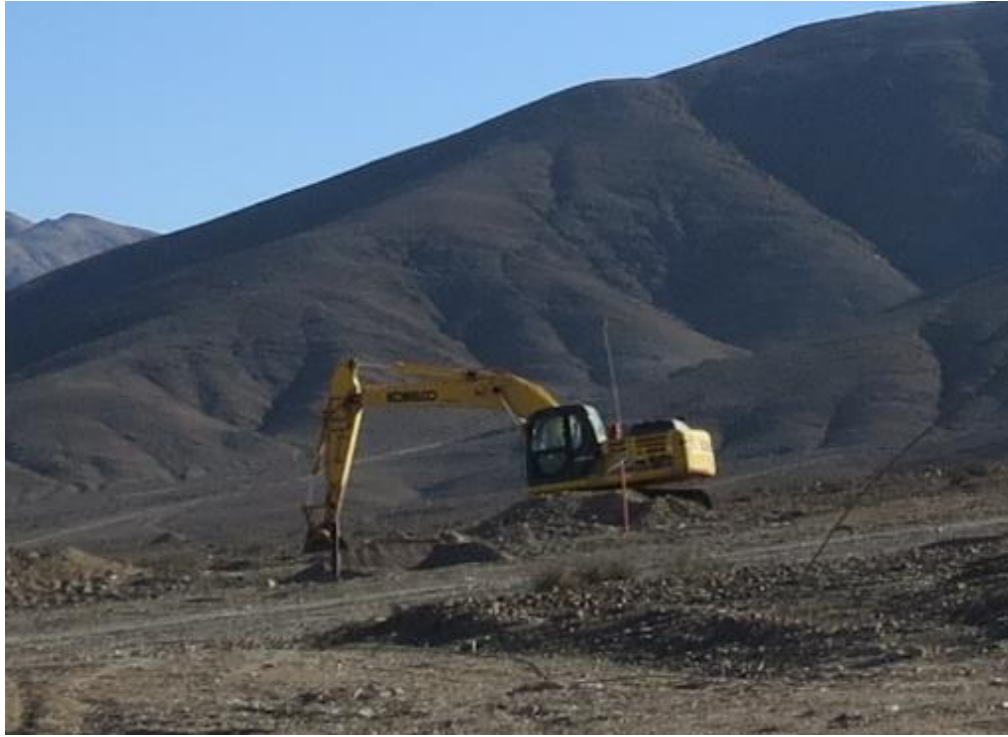
Fotografía N° 8. Máquina retroexcavadora de empresa Abengoa que provoca corte de conductor en fase lateral en vano entre estructura N°42 y N°43 de línea de 110 kV Cardones – Tierra Amarilla.
