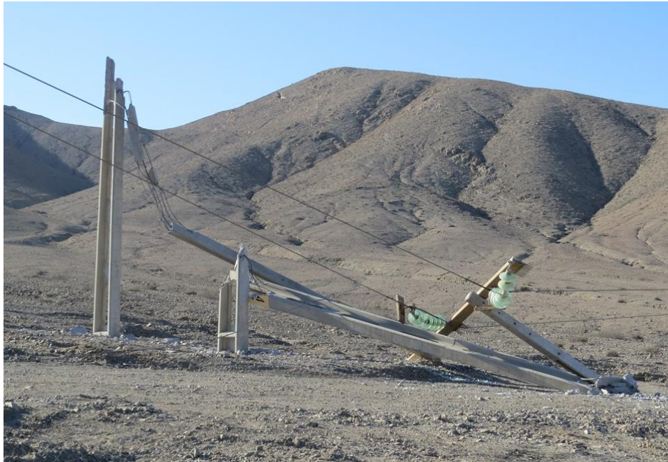
Fotografía N° 6. Estructura N° 43 colapsada, daños en poste, cruceta y aislación.
