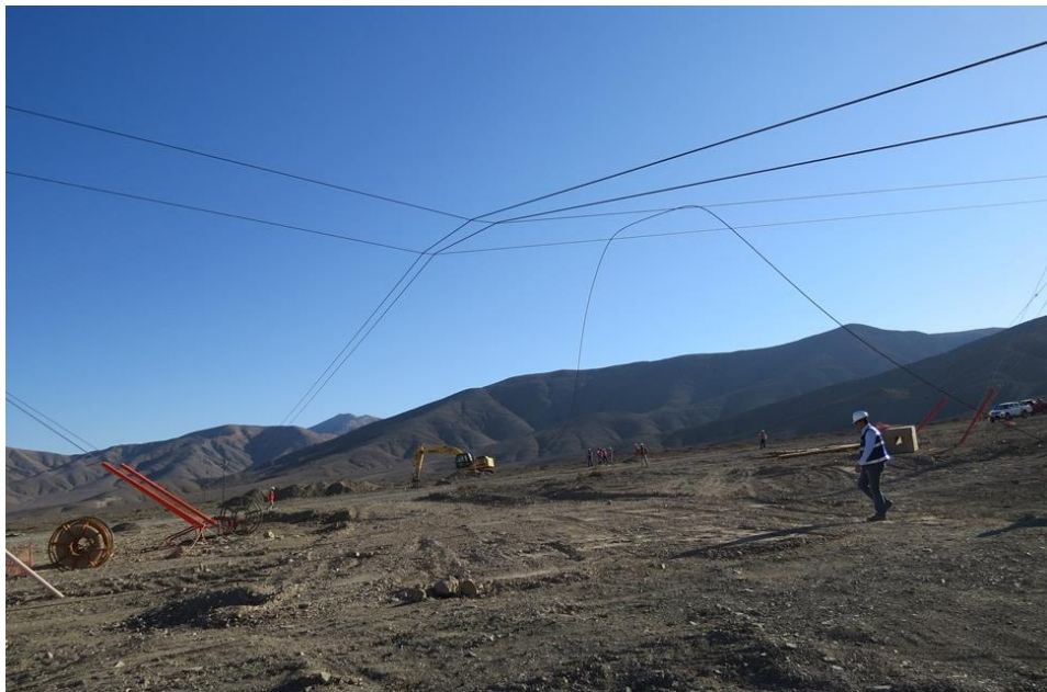
Fotografía N° 7. Conductores entre estructuras N° 42 y N° 43 de LT.110 kV Cardones - Tierra Amarilla, apoyados en LT. 110 kV Cardones – Magnetita (CAP).
