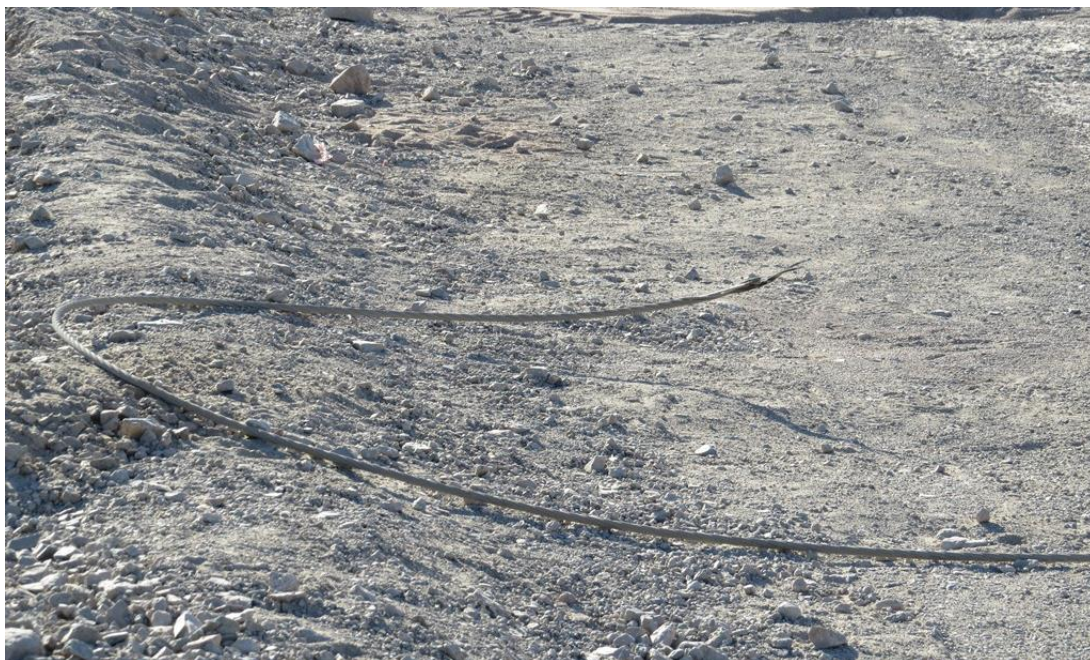
Fotografía N° 2. Evidente corte de conductor
