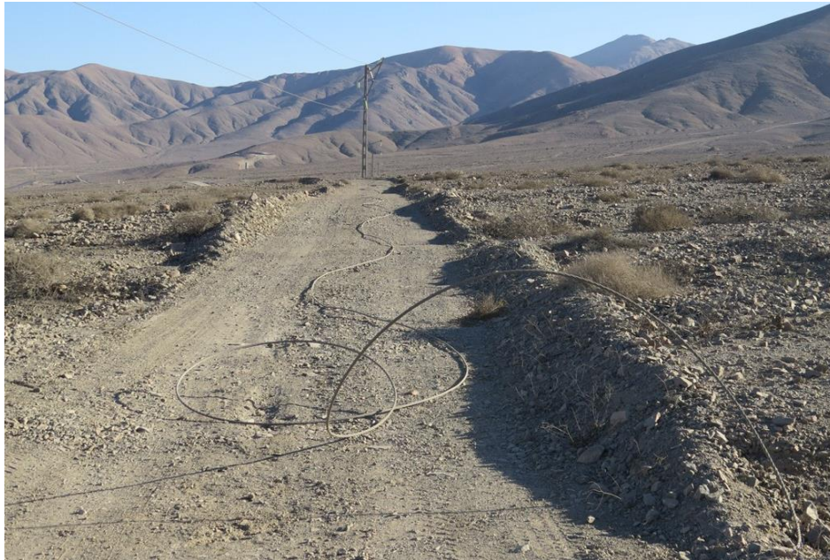
Fotografía N° 4. Conductor cortado recogido, al fondo estructura N° 42 colapsada
