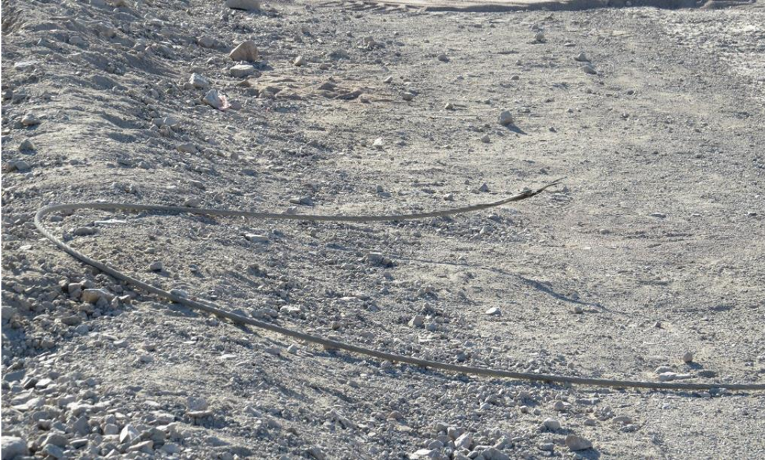
Fotografía N° 2. Evidente corte de conductor
