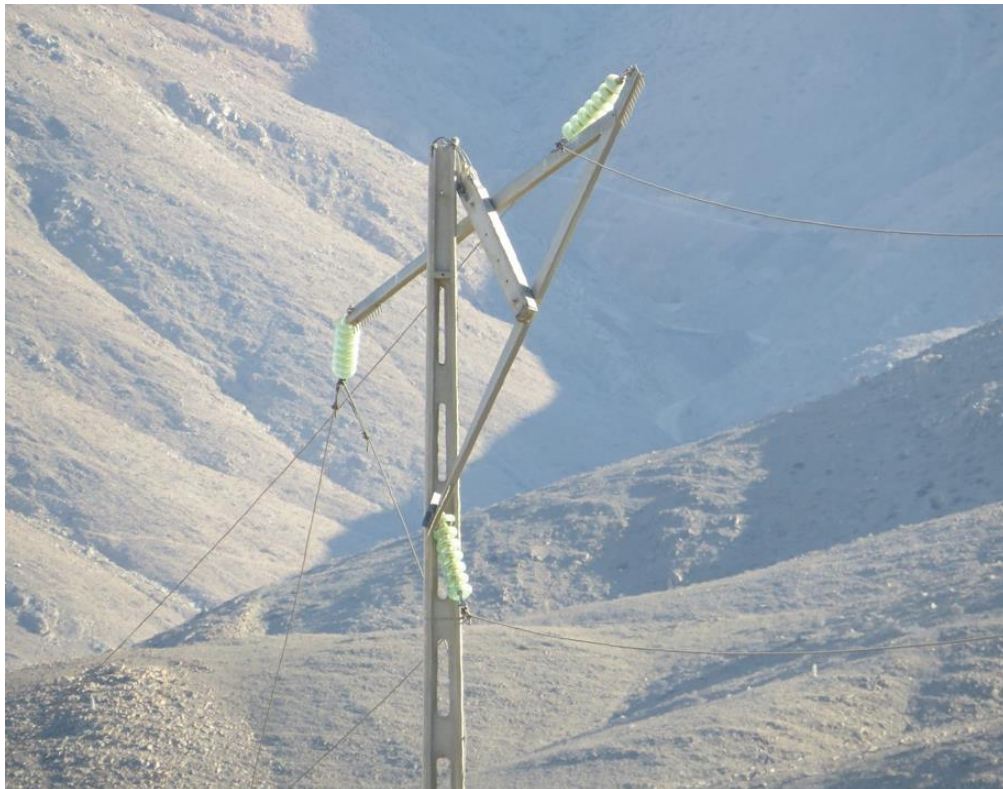
Fotografía N° 5. Estructura N° 42 colapsada, daños en poste y cruceta.
