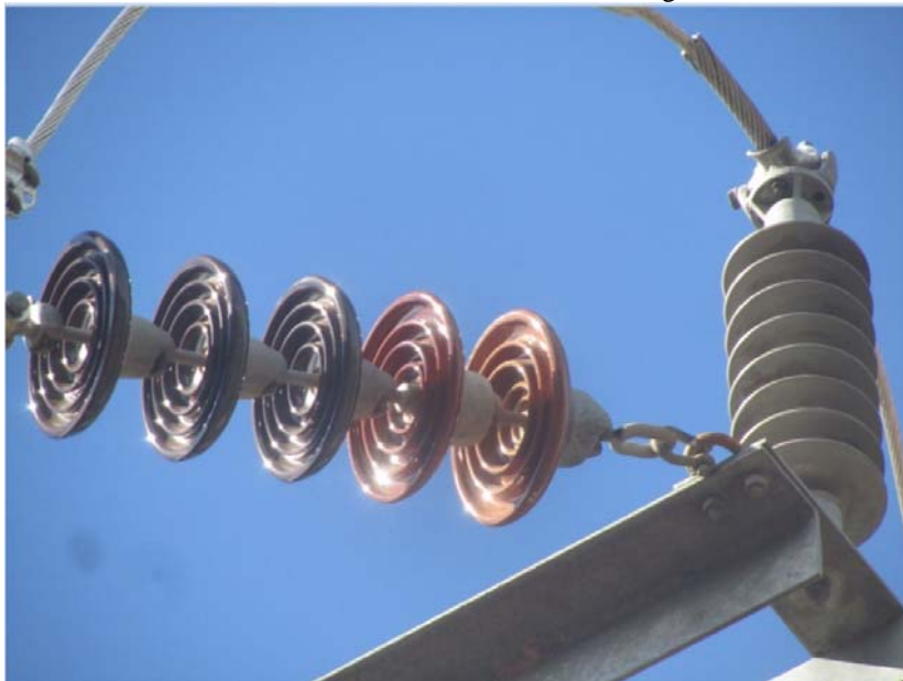
Se muestra cruceta correspondiente a estructura N°72 con señales de descarga producida por ave
