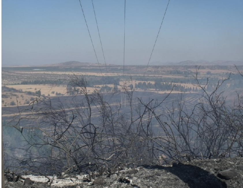
Foto N° 3: Tramo de la línea de 110 kV afectada directamente por el incendio forestal
