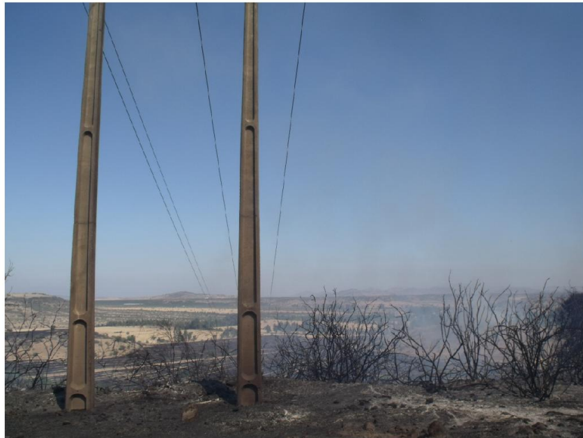
Foto N° 4: Tramo de la línea de 110 kV afectada directamente por el incendio forestal
