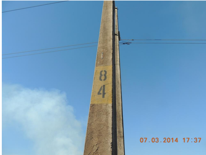
Foto N° 1: Se aprecia la estructura N° 84 afectada por el incendio
