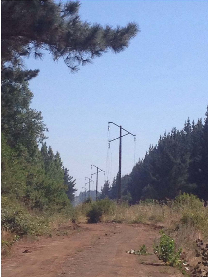
Fotografía N°2.- Se muestran las estructuras N°71 a la N°82 del tramo de línea 66kV Charrúa – Tap Tres Esquinas, afectadas por el robo de conductor.
