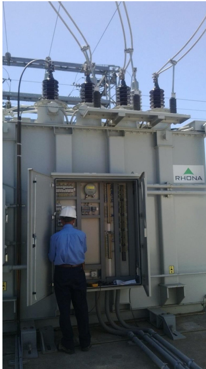
Foto N°1.- Revisión elementos gabinete transformador T3.
