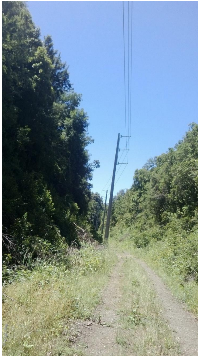
Figura N°8.- Vano entre estructuras N°73 y N°74 donde se registró falla.
