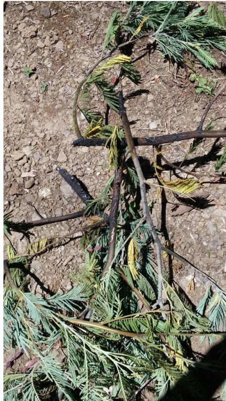
Figura N°7.- Resto de rama que hizo contacto con conductores.
