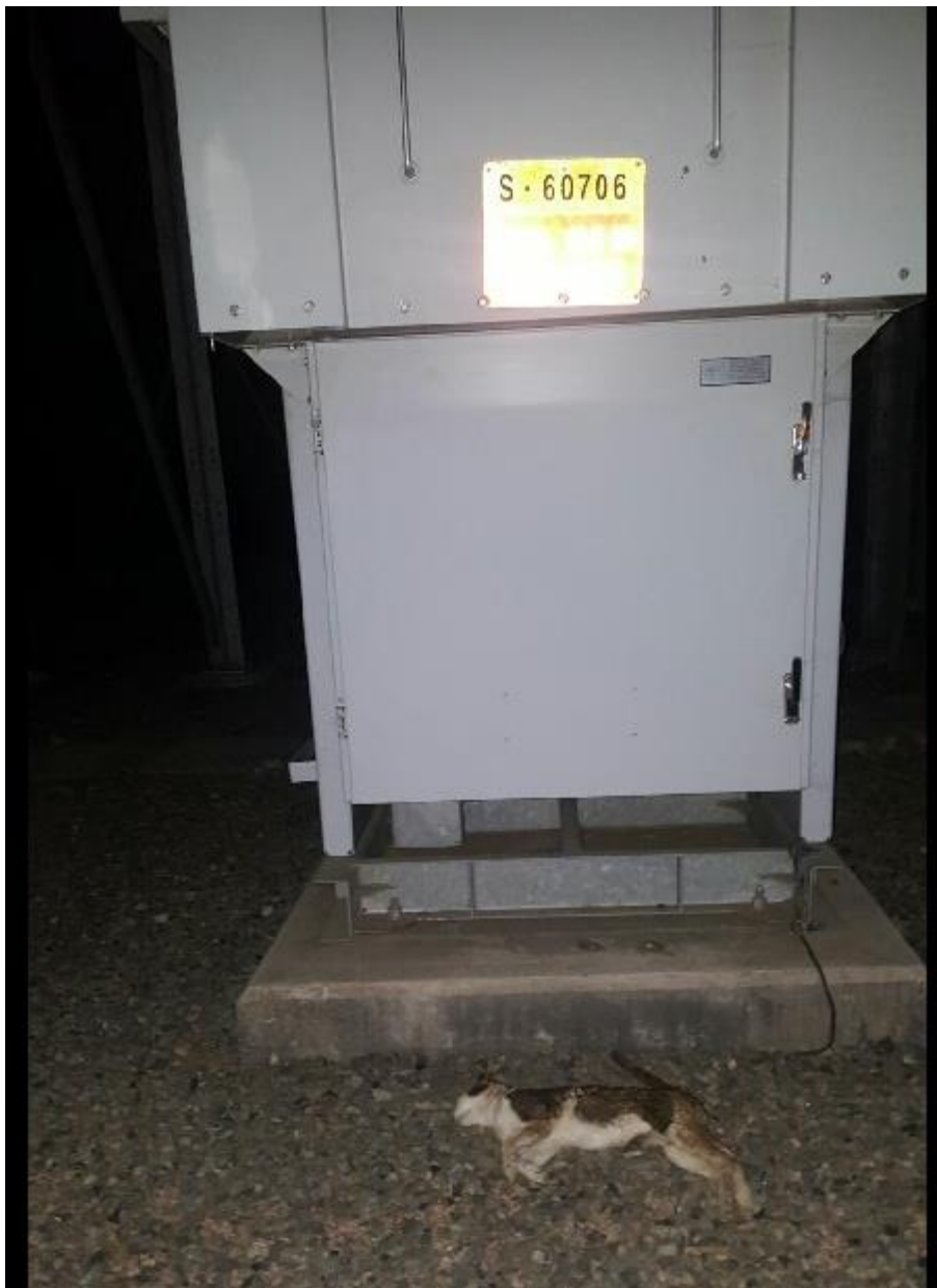
Fotografía N°2.- Gato electrocutado que provoca la falla.
