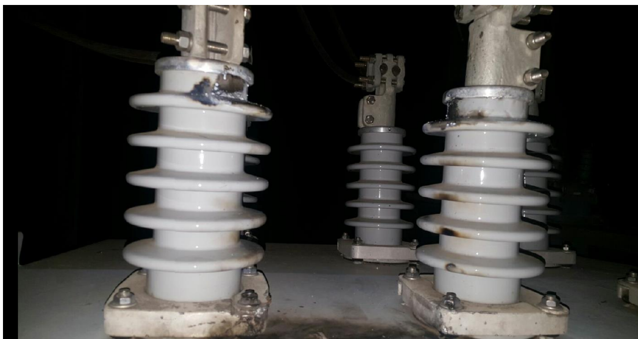
Fotografía N°1.- Indicios de descarga en busching del interruptor 52CT2 de S/E Los Angeles
