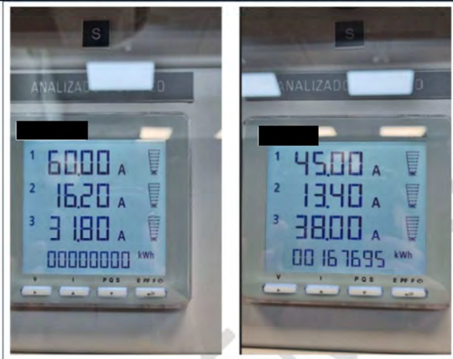
Figura 4. Carga de sistemas UPS edificio CNOT
