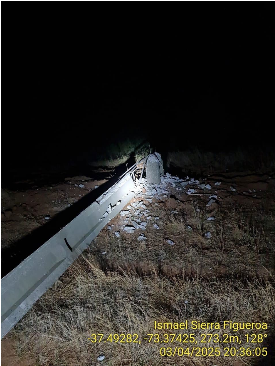
Fotografía N° 1: Poste de concreto correspondiente a estructura 387 de la línea LT 66 kV Curanilahue-Tres Pinos N° 1, derribado con mazo.
