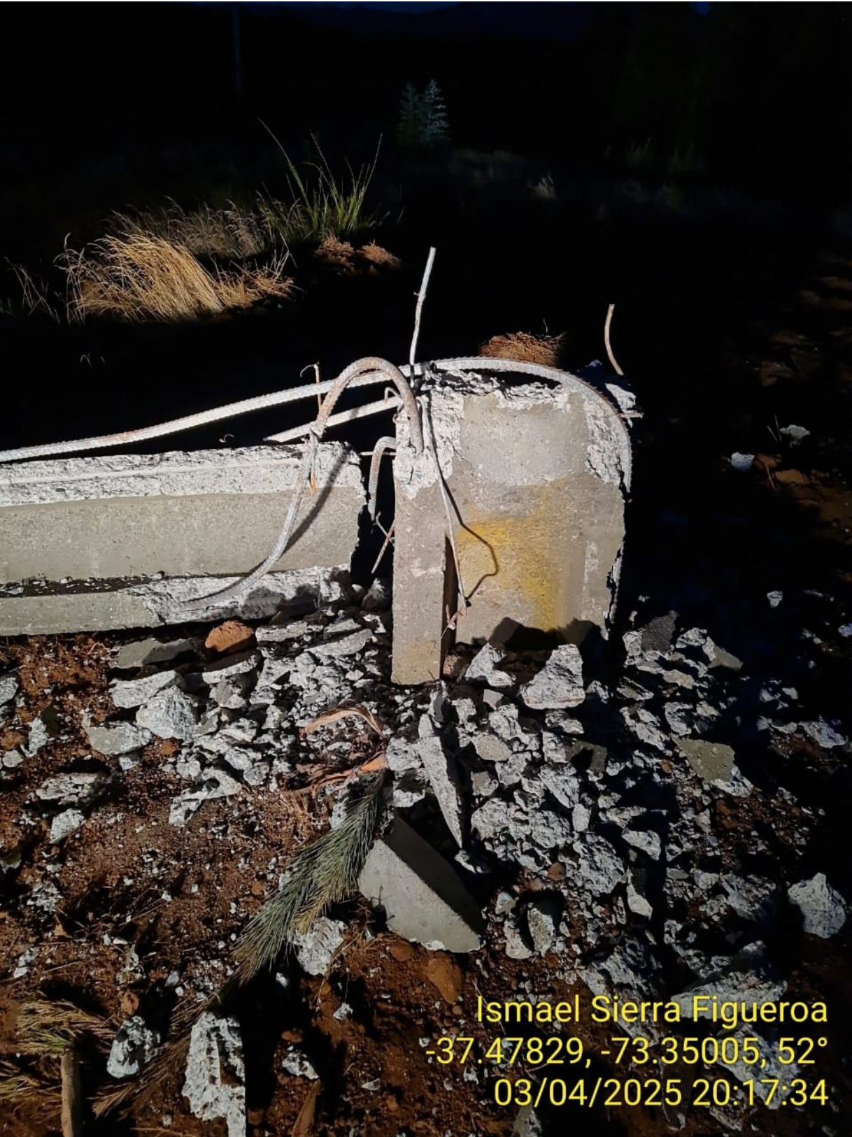
Fotografía N° 2: Poste de concreto correspondiente a estructura 387 de la línea LT 66 kV Curanilahue-Tres Pinos N° 1, derribado con mazo.
