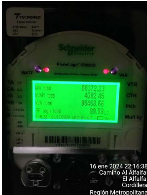
Fig. 5: Medidor de energía facturación U2.
