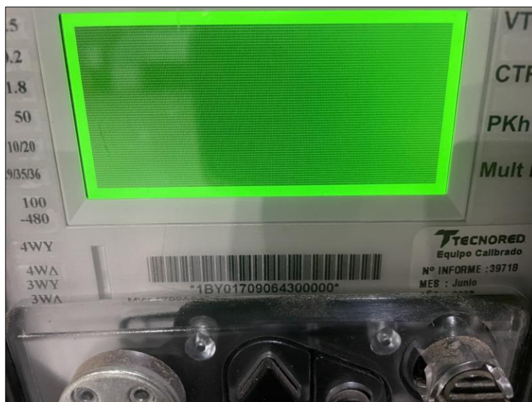
Figura 9.10 – Equipo medidor ION 8650 – Potencia bruta
