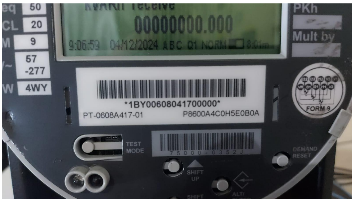
Figura 9.12 - Equipo medidor ION 8600 – Potencia SSAA
