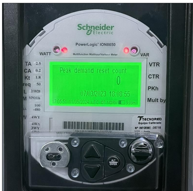
Figura 9.9 – Equipo medidor ION 8650 – Potencia bruta
