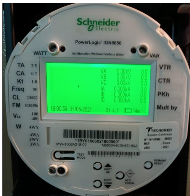
Figura 9-15 – Equipo medidor ION 8650 – Potencia bruta U2
