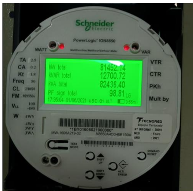
Figura 9-14 – Equipo medidor ION 8650 – Potencia bruta U1
