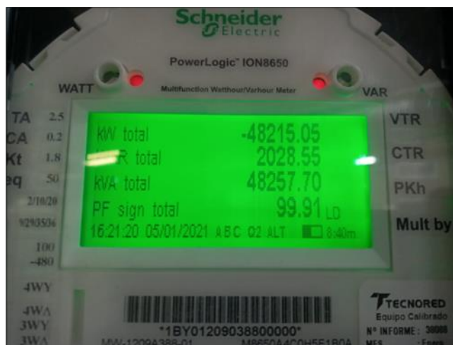
Figura 9-21 – Equipo medidor ION 8650 – Potencia neta U1
