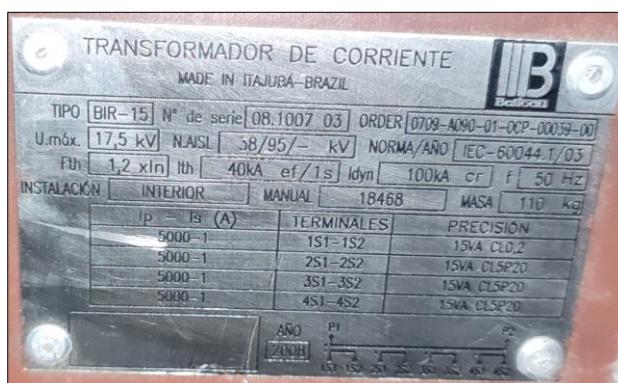
Figura 9-12 – Datos de placa de TTCC de generadores (Fases A-B-C)
