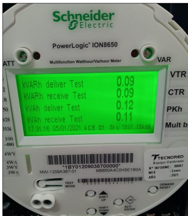
Figura 9-22 – Equipo medidor ION 8650 – Potencia neta U2
