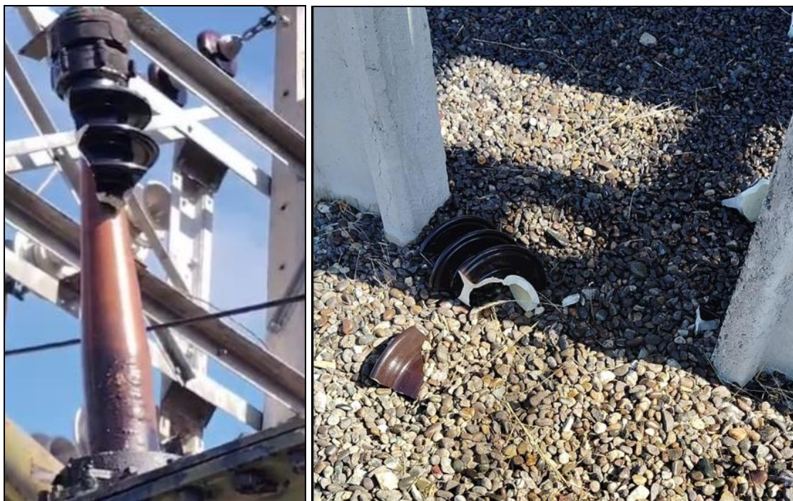
Figura 1: Aislación de bushing AT con daños.
