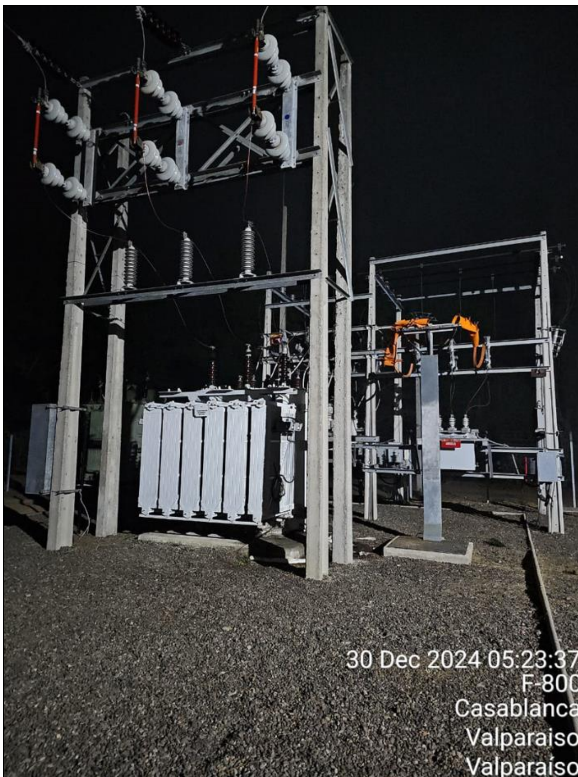
Figura 5: Transformador de reemplazo instalado.
