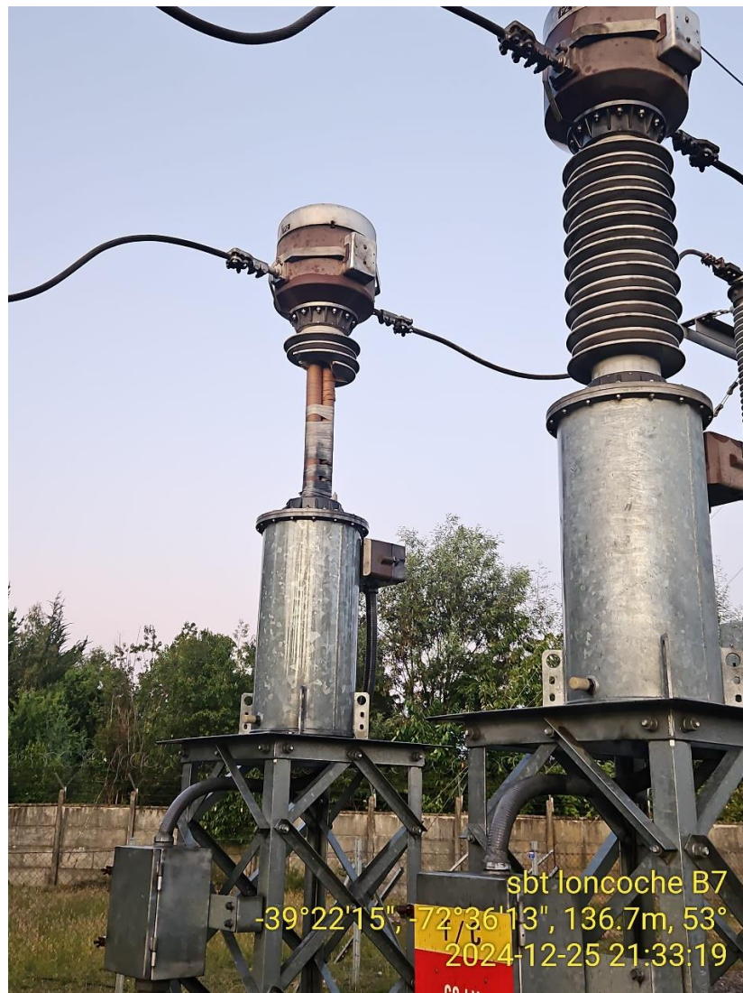
Fotografía 1. TTCC dañado en paño B7 de S/E Loncoche.
