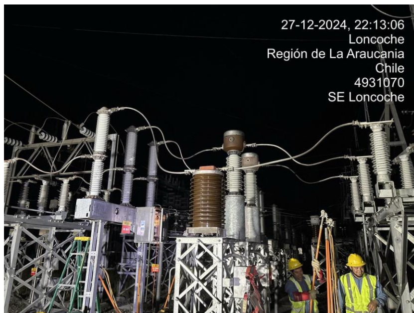
Fotografía 3. Disposición final de TTCC en paño B7 de S/E Loncoche
