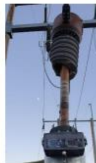
Figura 1.- Alerta por falla en este modelo de transformador de corriente de la misma marca.
