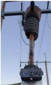
Figura 1.- Alerta por falla en este modelo de transformador de corriente de la misma marca.
