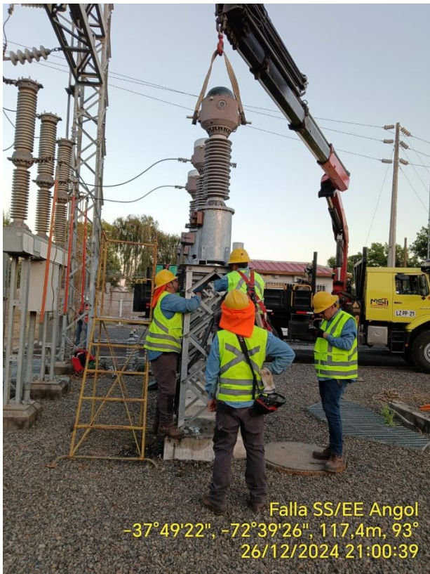
Fotografía N°1. Retiro del transformador de corriente del paño B1 dañado en S/E Angol.
