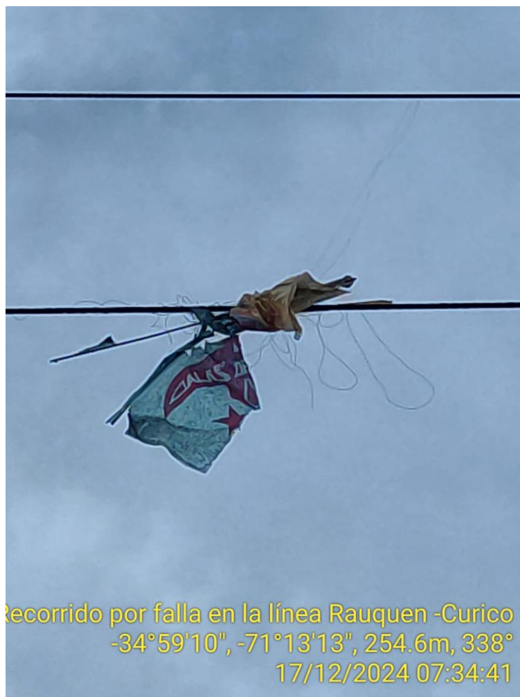
Figura 2 Elemento causante de falla en línea Rauquén – Curicó.
