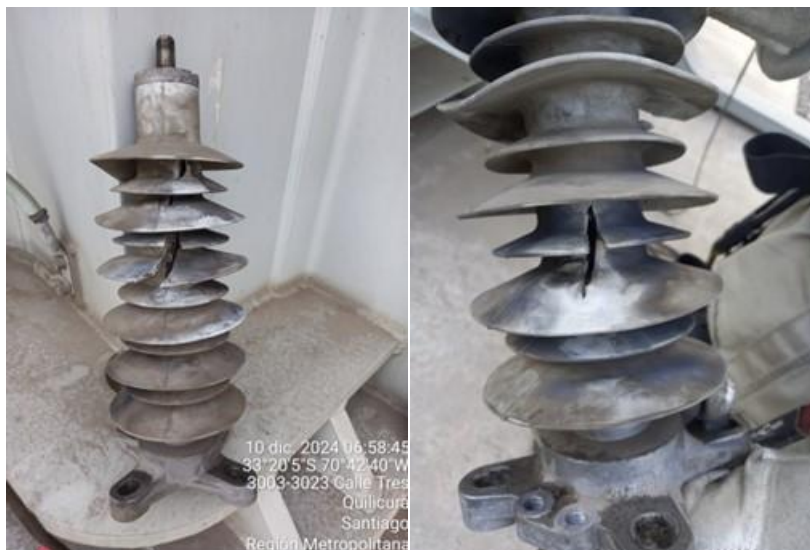
Pararrayo 23kV fase azul dañado
