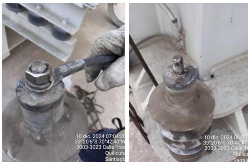
Pararrayo 23kV fase Blanca dañado
