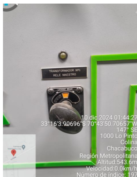
Relé maestro del TR1 operado
