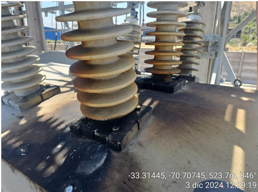
Figura 2: Bushing del interruptor 52E1.
