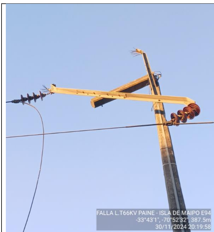
Figura 2.- La fotografía muestra los daños provocados por la caída del árbol sobre la LT66kV Paine – Isla de Maipo.
