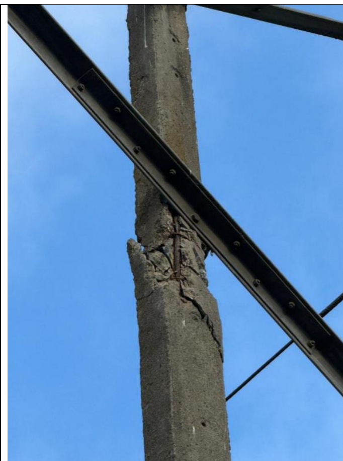
Figura 5.- La fotografía muestra los daños provocados por la caída del árbol sobre la LT66kV Paine – Isla de Maipo.
