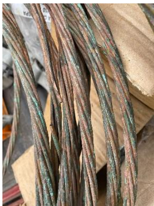
Imagen N°7: Conductor con aspecto verdoso con hebras cortadas.
