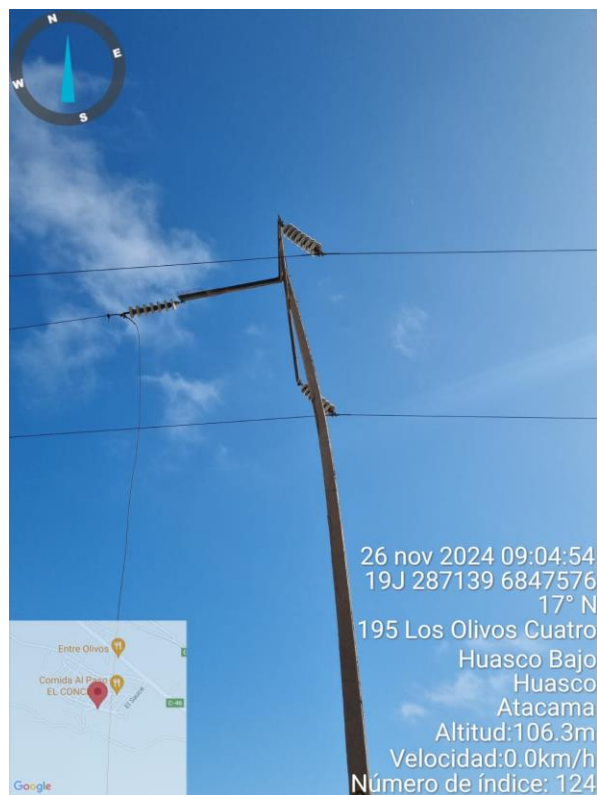
Imagen N°3: Estructura N°37 con cruceta con torcedura
