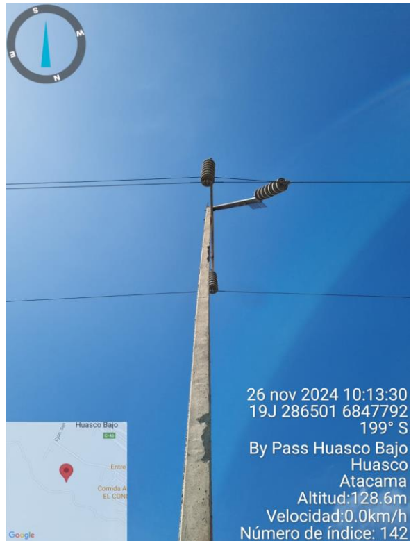
Imagen N°4: Estructura N°39 con cruceta con torcedura
