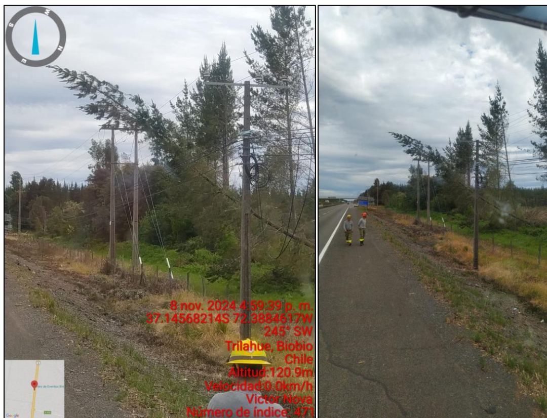
Figura 2: Evidencia de caída de árbol Estructura N°. 100
