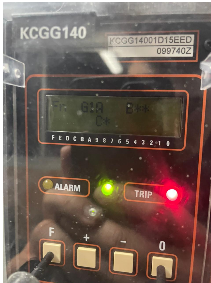
Figura 7 Registro de Operación Relé Alstom KCEG140
