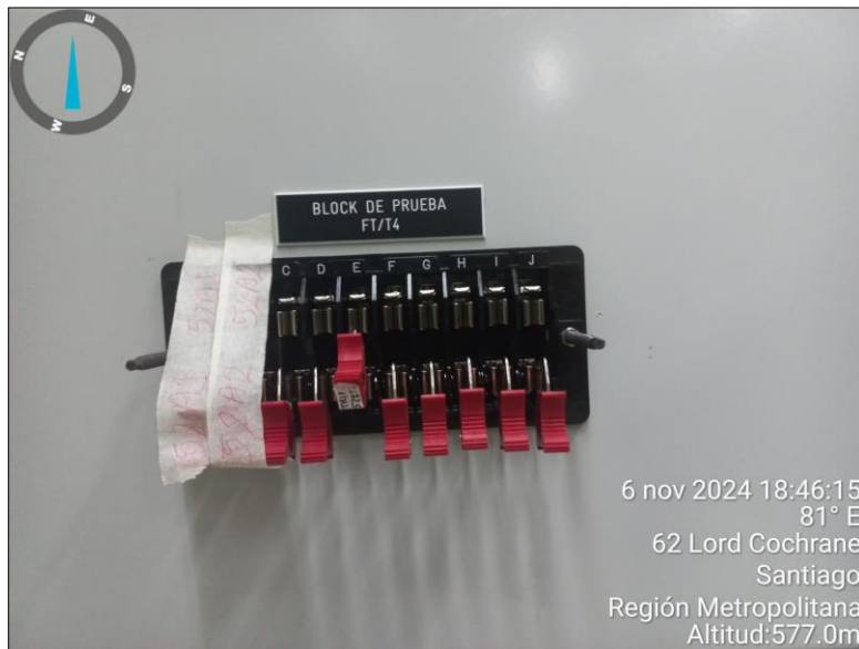
Figura N°5 – Imagen cuchillas TS relé maestro transformador N°4.
