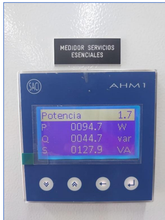
Fig. 3-14: Medidor servicios esenciales.
