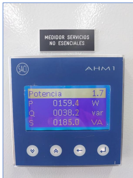
Fig. 3-13: Medidor servicios no esenciales.
