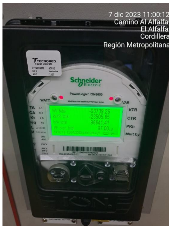
Fig. 4: Medidor de energía conectado a los bornes del generador unidad 2.
