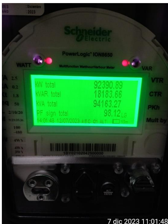
Fig. 3: Medidor de energía facturación.
