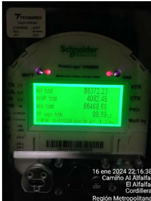
Fig. 5: Medidor de energía facturación U2.
