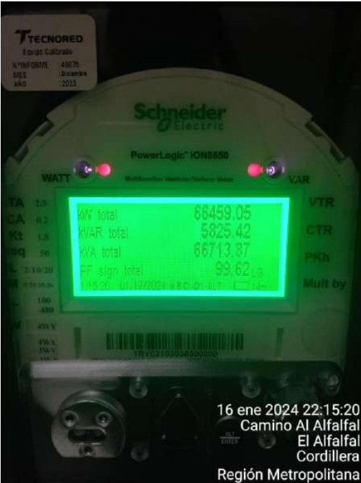
Fig. 3: Medidor de energía facturación U1.
