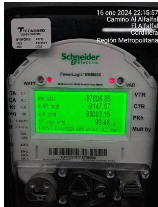
Fig. 6: Medidor de energía conectado a los bornes del generador unidad 2.
