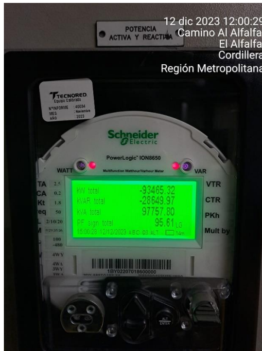
Fig. 4: Medidor de energía conectado a los bornes del generador unidad 1.
